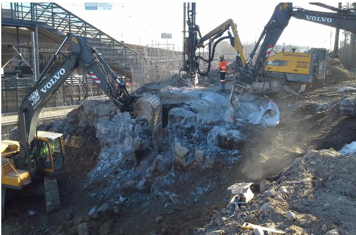
Kuva 9. Paisuntalaastin vaikutuksen jälkeinen kallion riktus ja rusnaus (Ilmalan juna-asema taustalla).
