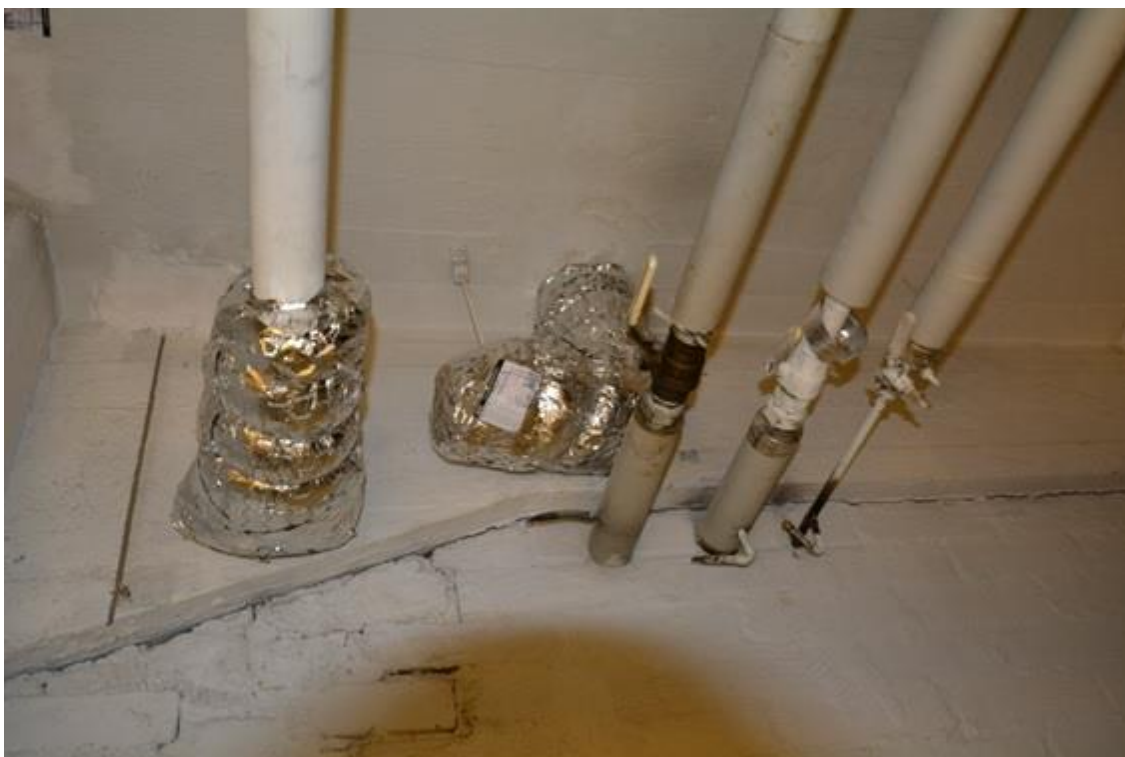
Kuva 10. Mineraalivillaeristys. Käytössä oleva putki eristetty detaljin mukaisesti 1 metrin matkalla, kun taas katkaistu käyttämätön putki eristetty detaljin mukaisesti kauttaaltaan.
