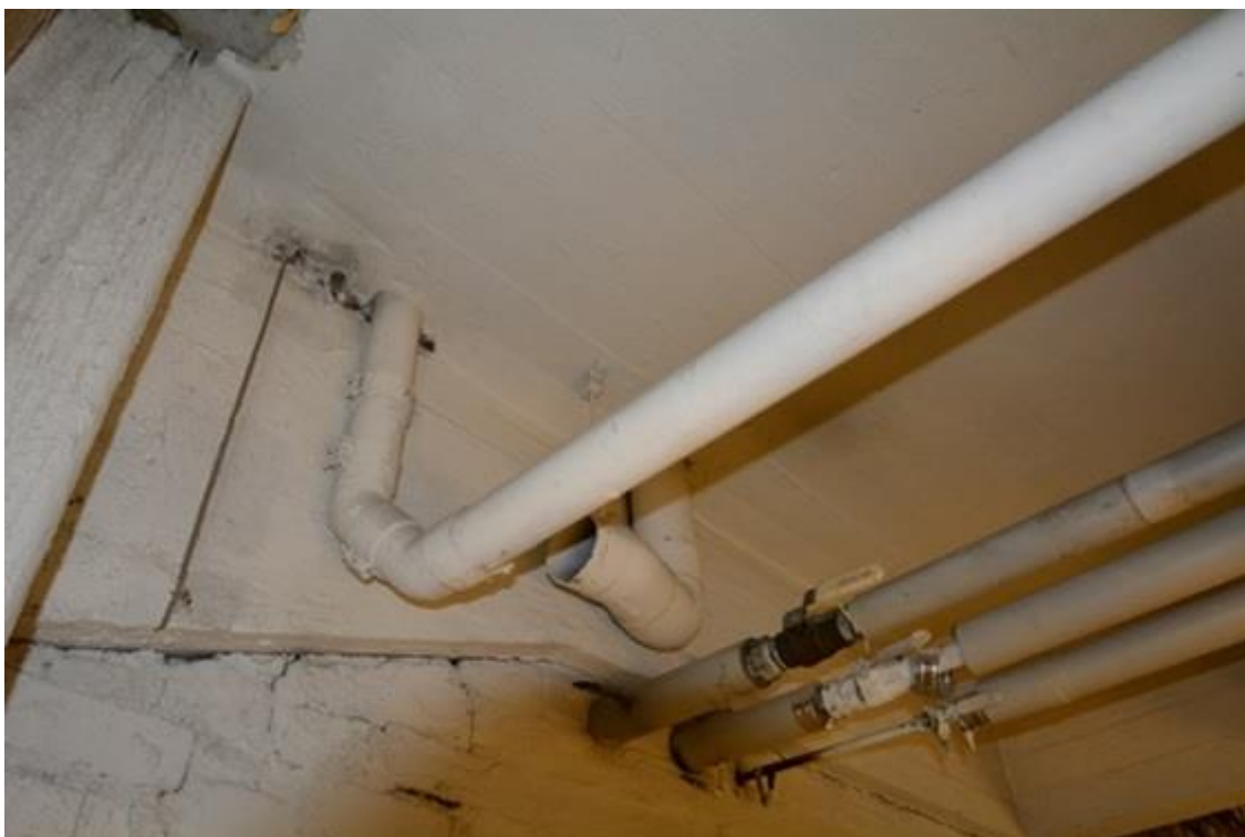
Kuva 8. Lähtötilanne palokatkoihin. Kaksi putkiläpivientiä ylös, joista toinen, oikeanpuoleinen, on katkaistu käyttämätön putki.
