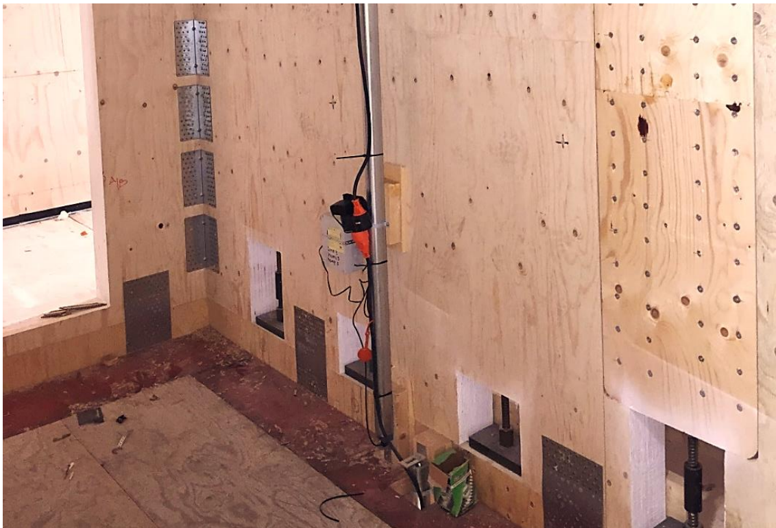
Kuva 11. Rungon painumista mittaava laite Joensuu Lighthousen hissikuilussa.
