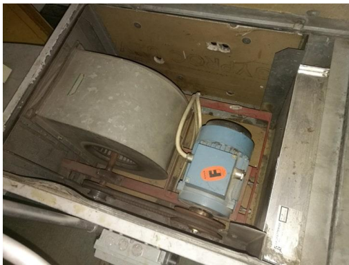
Kuva 46. Hihnäkäyttöinen radiaalipuhallin TK02.
