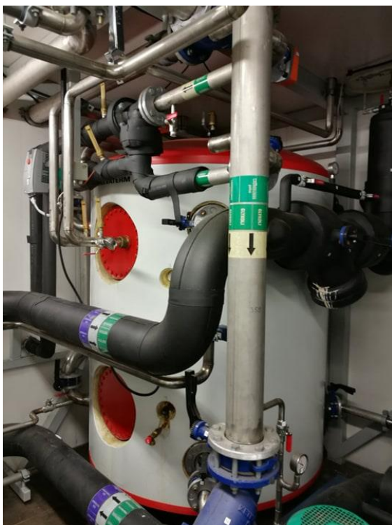
Kuva 40. Kylmäkonehuoneessa sijaitseva 3 m 3 lämminvesivaraaja hyödyntää lauhdelämmöstä saatavaa lauhdelämpöä käyttöveden lämmittämiseen.
