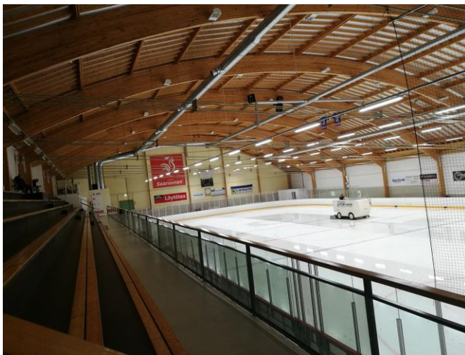
Kuva 33. Kangasalan jäähalli sisäänkäynnin suunnasta. Jäähallin päädyssä näkyvät IV-konehuoneesta lähtevät tuloilmakanavistot.
