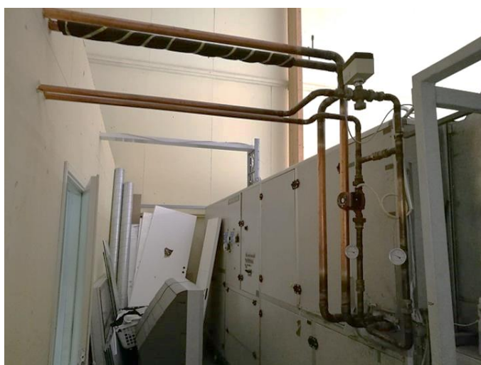
Kuva 58. IV-koneen lämmityspattereille menevät lämmitysjohdot ovat vain osittain eristettyjä
