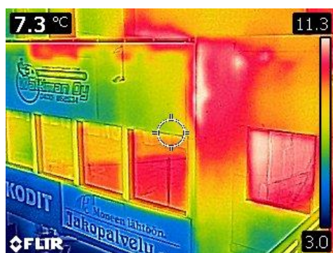
Kuva 56. Jäähallin kahvioista havaittiin lämpimien ikkunapintojen lisäksi lämpövuotoja saumakohtista.
