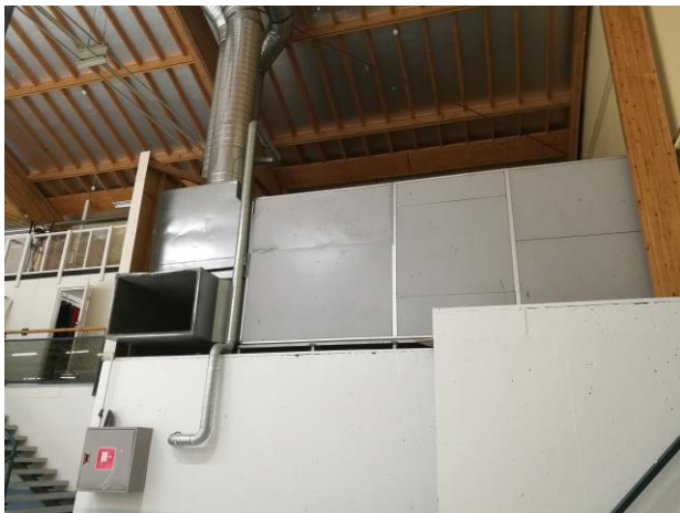
Kuva 43. Poistoilma otetaan pistemäisesti ilmanvaihtokoneen sivusta. Poistoilmakanavisto ja 2 tuloilmakanavistoa nousevat ilmanvaihtokoneen päältä katon rajaan.
