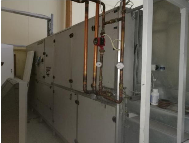
Kuva 42. TK01 Findri Adej 4000 IV-konehuoneesta katsottuna. IV-koneen sisään- ja ulospuhallussäleiköt sijaitsevat jäähallin ulkoseinällä. Kuvassa näkyvät lauhdelämpö- ja lämmityspatterin putkistot. Taka-alalla kondenssikuivaimelle menevät sähkökaapelit.
