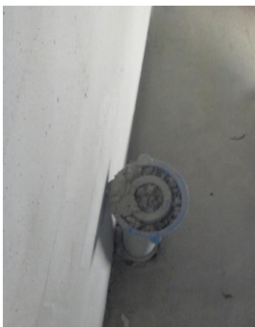
Kuva 9. Piikkaustyö edessä. WC-istuimen viemäri jäänyt liian lähelle seinää. Lähde Marko Lehtonen
