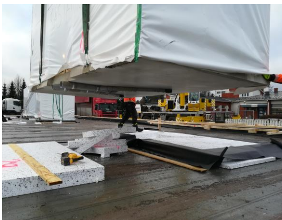
Kuva 10. Aiemmin kylpyhuonemoduulin viemärit sijaitsivat betonilaatan pohjassa. Lähde Lehdon tietokanta
