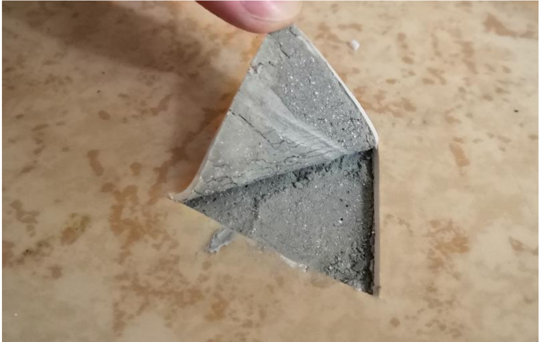
Kuva 17. V1, taukotila 018. Viiltomittauksen tulos 64,7 %RH. Maton tartunta alustaansa heikko, asennettu likaiselle tai pölyiselle alustalle, ei poikkeavaa hajua tai värimuutoksia, murtopinta tasoitteessa.
