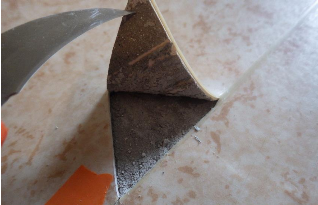
Kuva 19. V3, H021 wc-oven edusta, jossa hieman kohonneita lukemia pintakosteusmittarilla. Viiltomittauksen tulos 69,4 %RH. Maton tartunta alustaansa heikko, asennettu likaiselle tai pölyiselle alustalle, ei poikkeavaa hajua tai värimuutoksia, murtopinta tasoitteessa.
