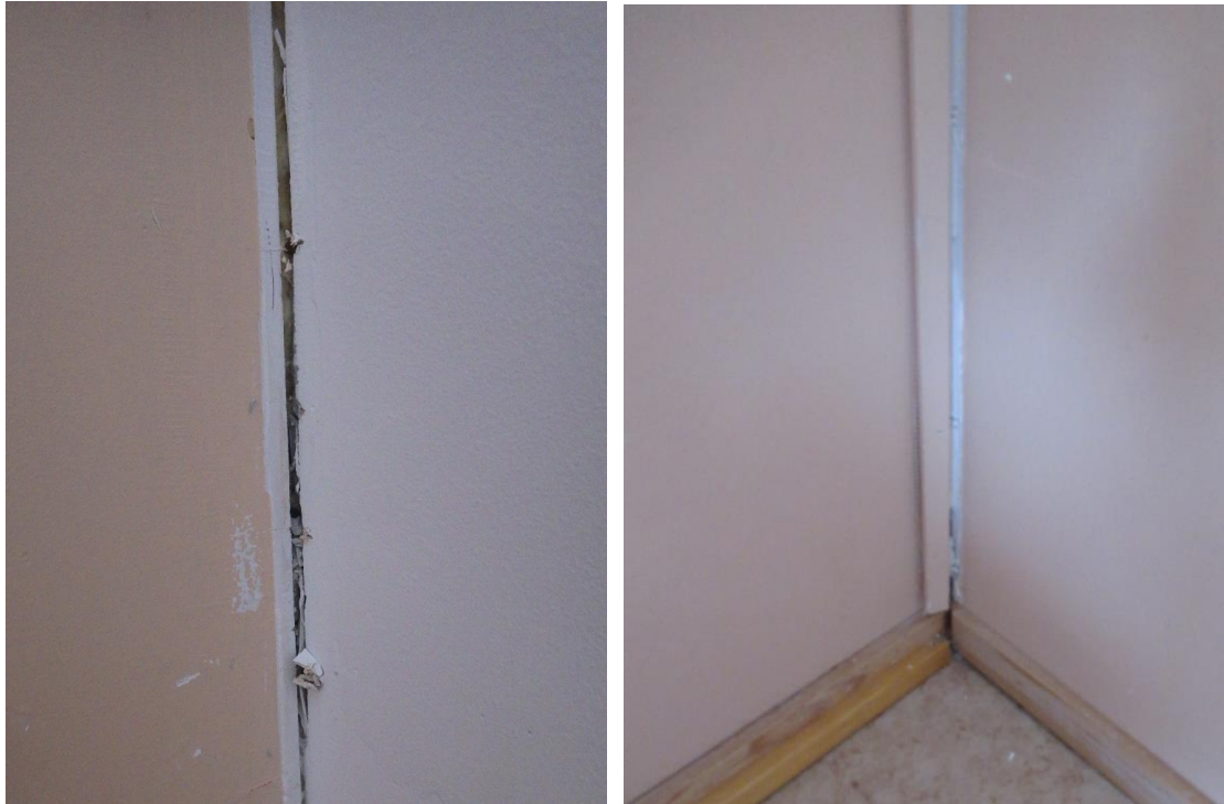
Kuva 35 a ja b. Ulkoseinien sisänurkassa rako, jossa näkyy höyrynsulun epäjatkuvuuskohta sekä ilmayhteys eristetilaan, huone H001 (kuva a). Eteläpäädyssä väliseinän ja ulkoseinän liittymäkohdassa rako, jota on paikattu listalla ja elastisella massalla (kuva b).
