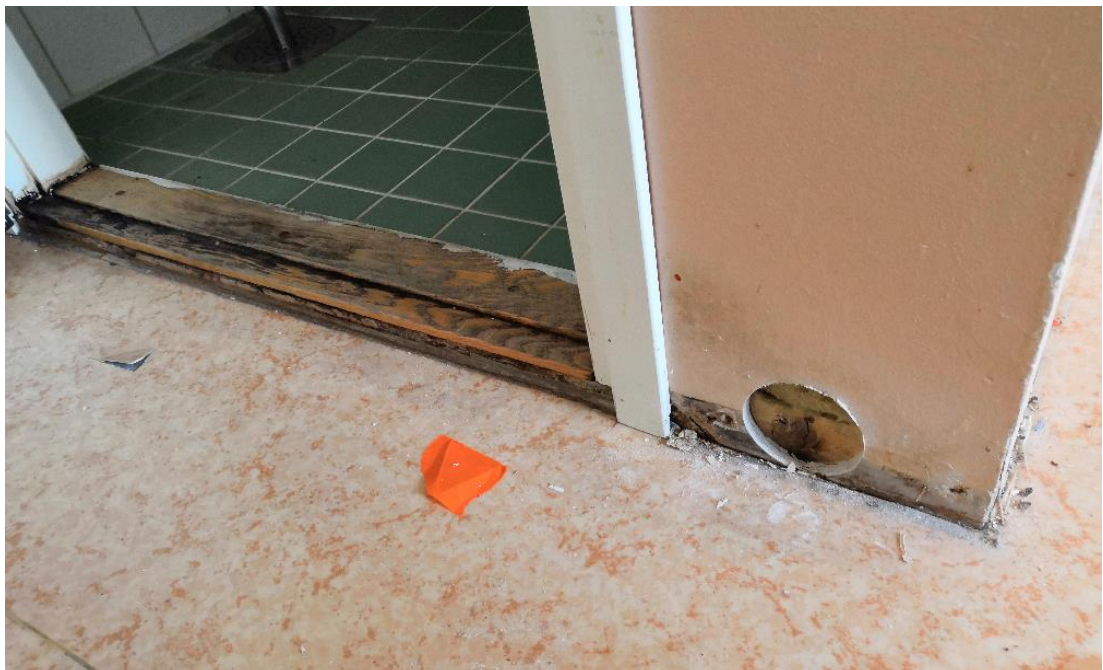
Kuva 36. Huoneen H001 wc-tilan kynnyksessä, oven alareunassa ja väliseinärakenteissa havaittiin kosteusvaurio. Levyseinä on vaurioitunut aistinvaraisesti arvioituna kynnyksen vasemmalla puolella harkkorakenteiseen väliseinään asti ja kynnyksen oikealla puolella n. 40 cm päähän kuvassa näkyvästä kulmasta ulkoseinän suuntaan.
