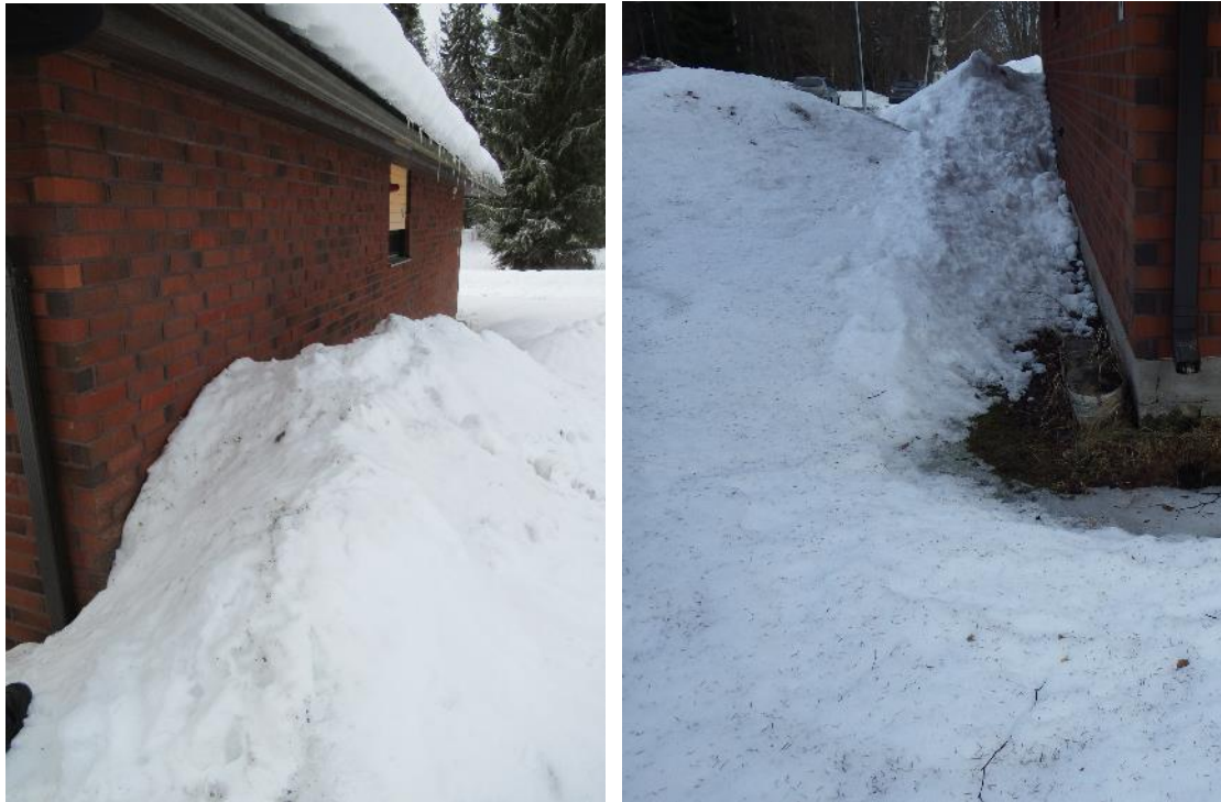
Kuva 7 a ja b. Pohjoispäädyn pysäköintialueen lumet aurattu julkisivua vasten. Lumi muuttaa paikallisesti seinärakenteen rakennusfysikaalista toimintaa ja aiheuttaa sulassaessaan rakenteisiin voimakkaan kosteusrasituksen.
