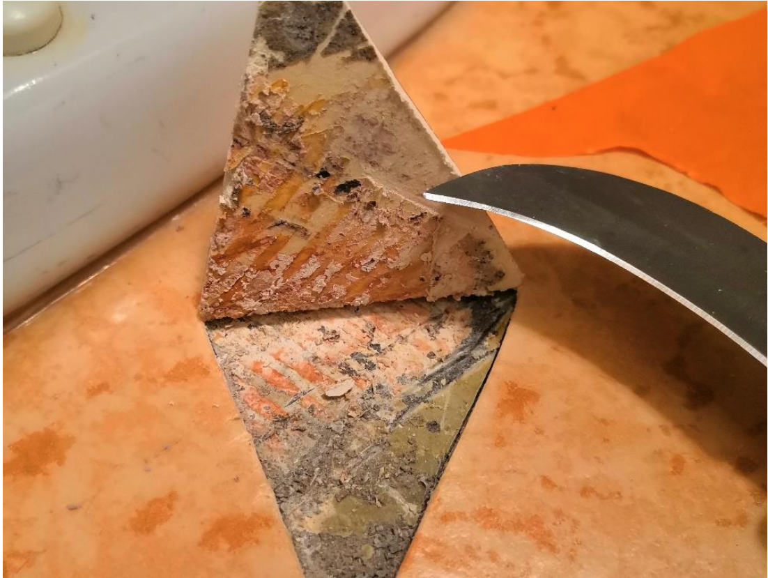
Kuva 43. V7, huoneen H009 wc-tila. Viilto mittauksen tulos 92,4 %RH. Maton tartunta ok, voimakas pistävä haju, selkeitä värimuutoksia, murtopinta liimassa/matossa/tasoitteessa.
