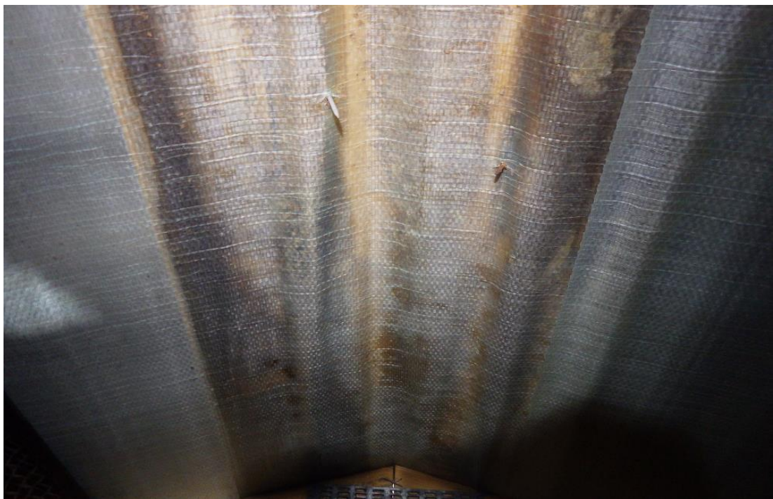
Kuva 50. Katon harjakohdan aluskatteessa ja harjalaudoituksessa havaittiin kosteusjälkiä. Sadevesi pääsee tiivistämättömän harjaliitoksen kautta aluskatteen päälle. Rakenteessa ei ole harjatuuletusta.
