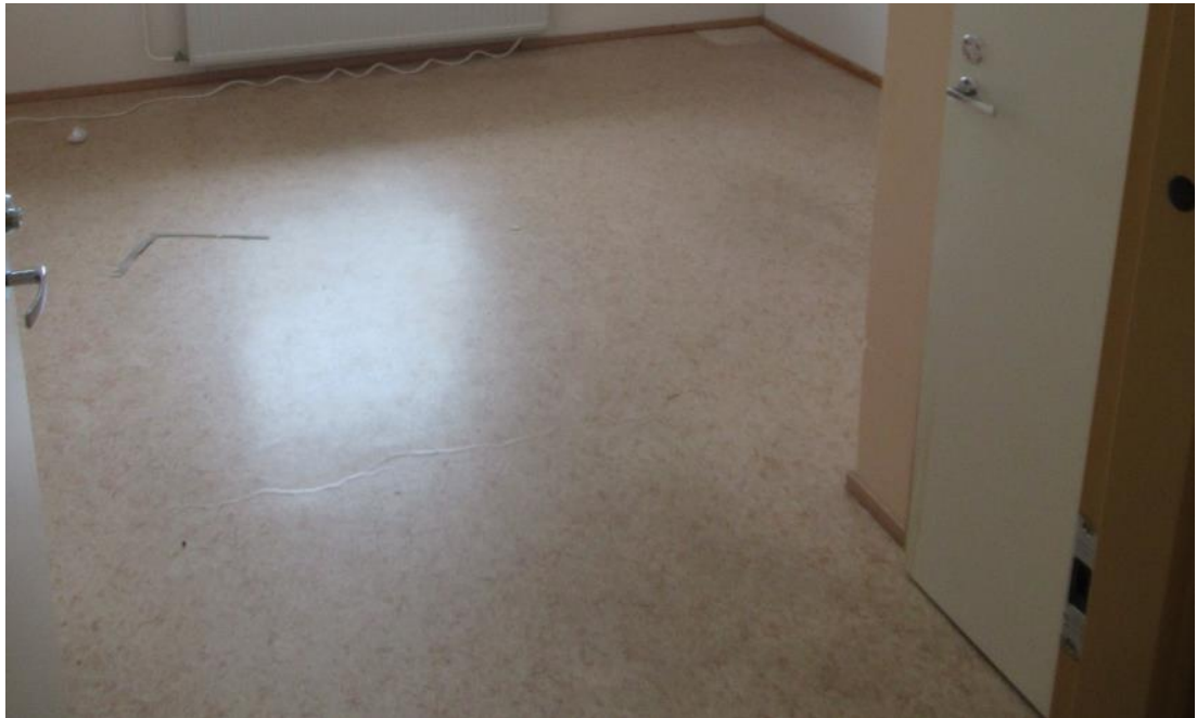
Kuva 10. Yleiskuva huonetilan muovimatosta. Matossa havaittiin paikoitellen käytöstä johtuvia värimuutoksia.
