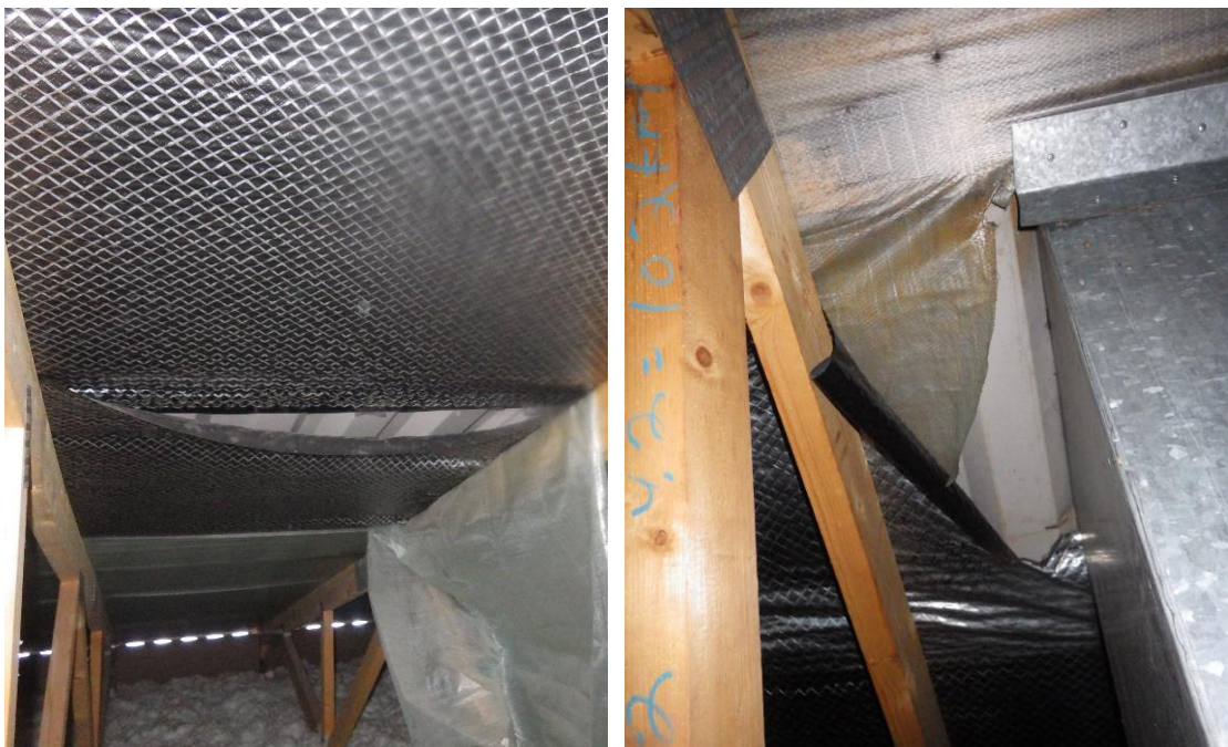
Kuva 54 a ja b. Aluskatteessa havaittiin paikoitellen selviä epätiiveyskohtia (kuva a). Huippumurin ja aluskatteen liitos epätiivis, jonka kautta sadevedet ohjautuvat yläpohjaan (kuva b). Aluskatteena oli käytetty kahta eri materiaalia. Aistinvaraisesti havainnoituna yläpohjatila tuulettui hyvin räystäiden kautta.
