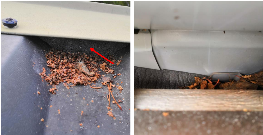
Kuva 49. Osassa katetta harjapellin ja katteen välinen solumuovitiiviste (kuva a nuoli) puuttui. Kuva b otettu puuttuneen tiivisteen kohdalta, josta havaitaan avoin yhteys ulkotilasta harjan ruodelaudoitukseen. Osa katenauloista oli löystynyt (kuva a).
