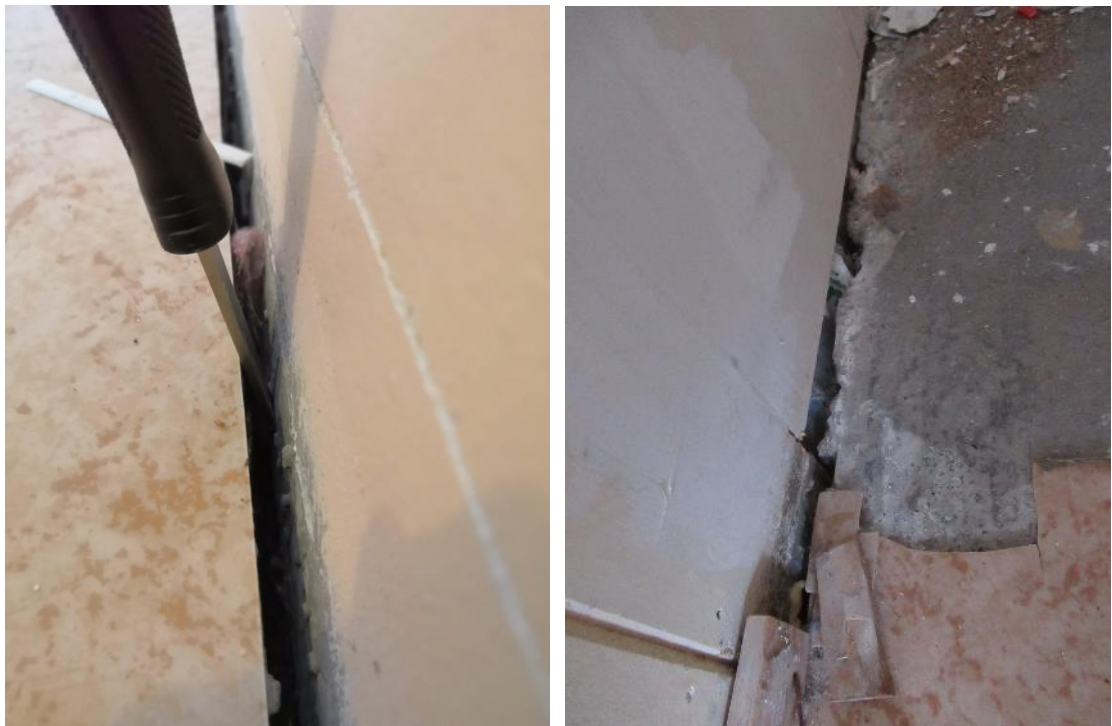
Kuva 11 a ja b. Alapohjan ja ulkoseinän välinen liittymä tiivistämättä tai puutteellisesti tiivistetty kaikissa huonetiloissa. Osassa liittymiä näkyi jälkiasennettu uretaanivaaho, jossa on ilmatiiveyspuutteita. Betonilaatan ja seinärakenteen välissä n. 1,5 cm rako. Kuvassa b on esitetty tilan H030 alapohjan ja seinärakenteen liittymä poistettujen kalusteiden kohdalta. Sisäverhouslevy jatkuu lattiapinnan alapuolelle.
