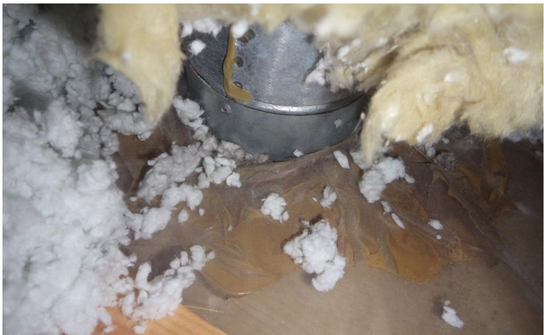
Kuva 56. Poistoilmakanavien läpiviennit tiivistetty ruskealla ”pakkausteipillä”, joka haurastuu ikääntyessään. Liitoksien ilmatiiveydessä havaittiin puutteita.
