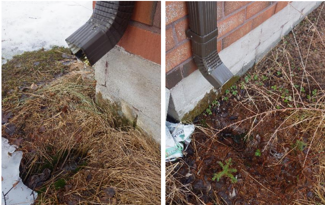
Kuva 5 a ja b. Betonikourut ovat hautautuneet kasvuston alle, eivätkä toimi tarkoituksenmukaisesti. Syökytorvista tuleva hulevesi kastelee sokkelia, mikä on havaittavissa sokkelipinnan sammaloitumisena.
