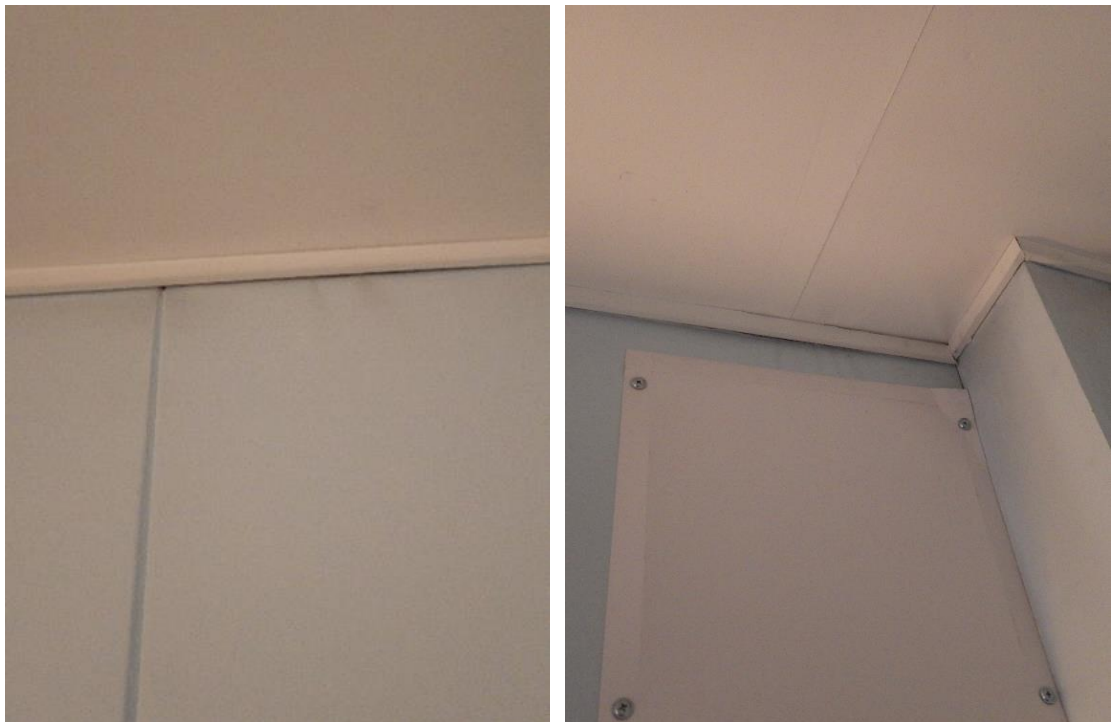
Kuva 62 a ja b. Yläpohjan ja seinän liittymäkohdissa havaittiin sisätilaan päin tulevan ilmavuodon aiheuttamaa tummumista, joka viittaa tilojen alipaineisuuteen.
