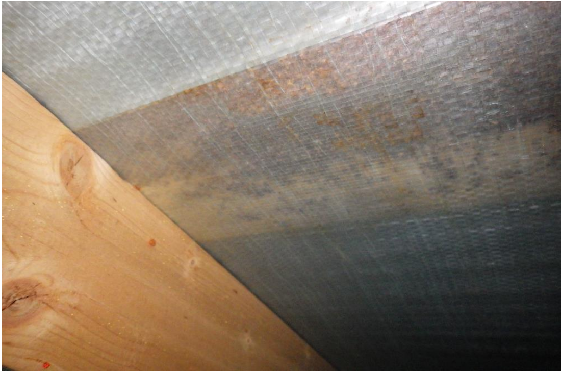
Kuva 53. Aluskatteen ruodelaudoituksen välistä puuttuu yläpaarteen suuntaiset korotusrimat, joilla parannetaan aluskatteen ja vesikatteen välitilan tuulettuvuutta. Ruodelautojen ja aluskatteen väliin on kulkeutunut harjalta tulevia roskia. Puutteellisesta rakenteesta aiheutuu ruodelaudoille kosteusrasitusta, eikä sadevedet pääse poistumaan esteettömästi aluskatteen päältä.
