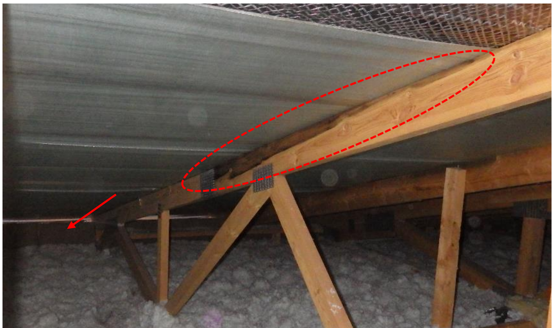
Kuva 52. Naulalevyristikoiden yläpaarteissa havaittiin runsasta kosteusrasitusta paikallisesti. Yläpaarteen yläpinnan kohdalla havaittiin aluskatteessa reikiä, josta sadevesi on kulkeutunut yläpaarteeseen. Ulkoseinän tuulensuojalevy nousee noin 20 cm yläpohjan eristeen yläpuolelle, varsinaisia tuulenohjaimia ei havaittu (punainen nuoli).
