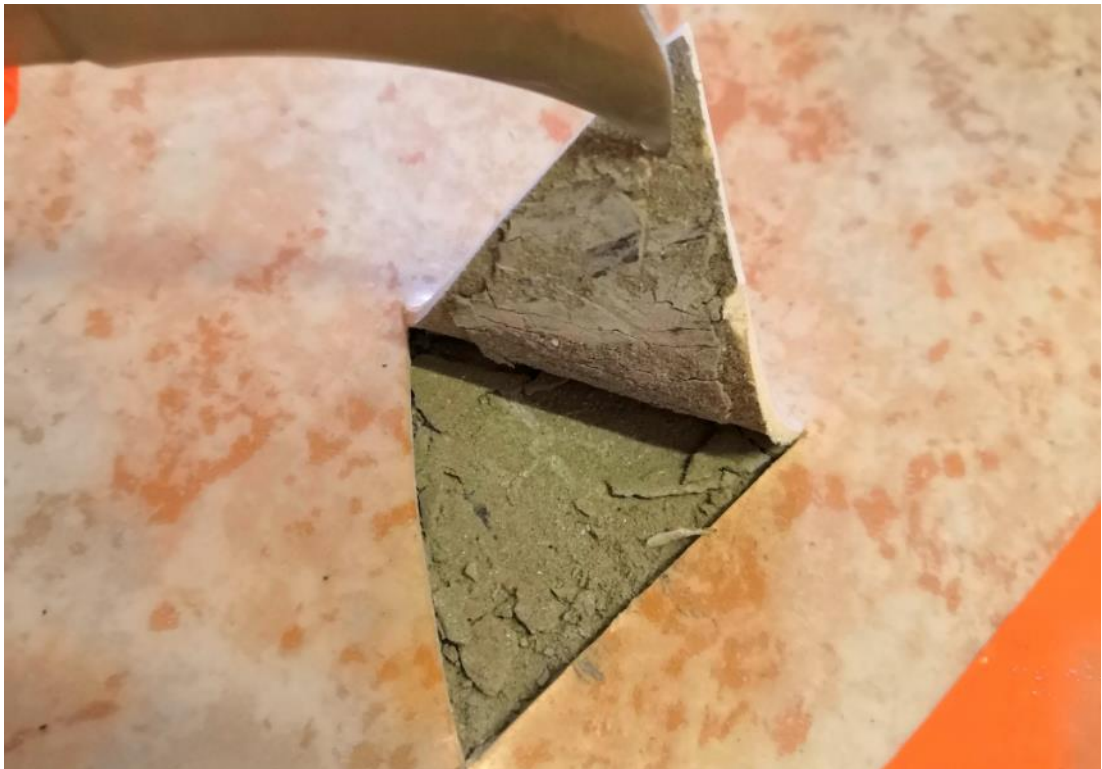
Kuva 20. V4, käytävän pohjoispääty. Viiltomittauksen tulos 68,1 %RH. Maton tartunta alustaansa heikko, asennettu likaiselle tai pölyiselle alustalle, ei poikkeavaa hajua tai värimuutoksia, murtopinta tasoitteessa.
