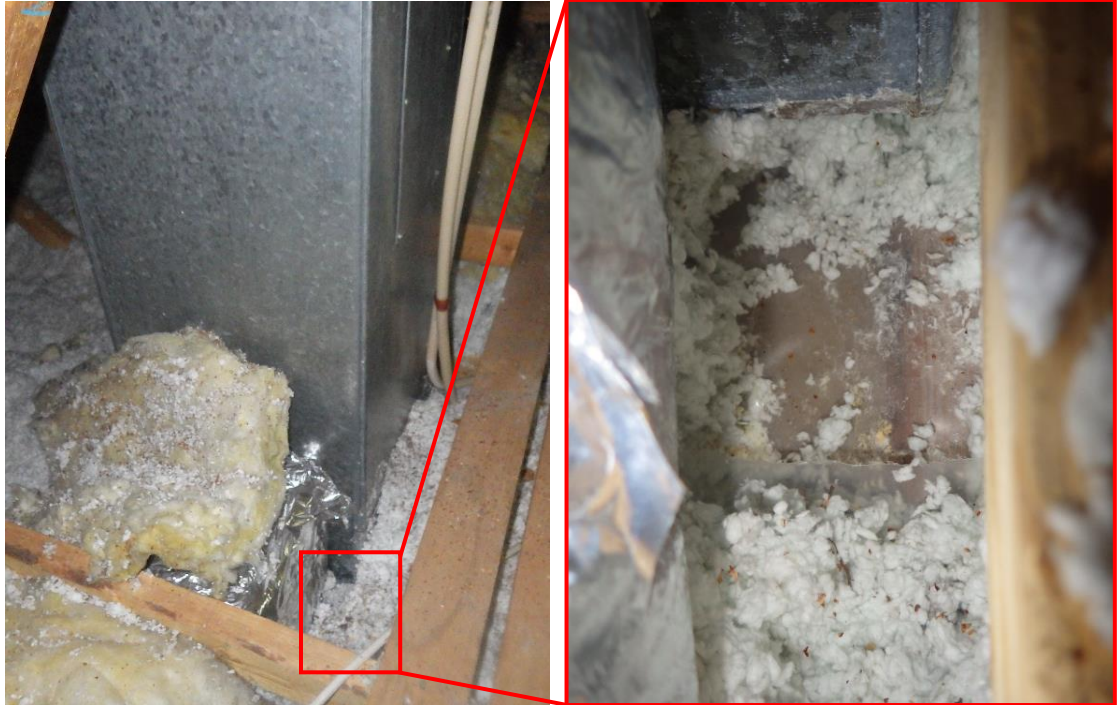
Kuva 55 a ja b. Huippuimurin kyljissä havaittiin valumajälkiä. Huippuimurin alapuolella puhallusvilla on kosteuden vaikutuksesta paakkuuntunut. Höyrynsulun sauma on tiivistänyt, jonka kautta kosteutta on päässyt sisäverhoukselle päälle (kuva b, sisäpuolen vaurio esitetty kuvassa 61).
