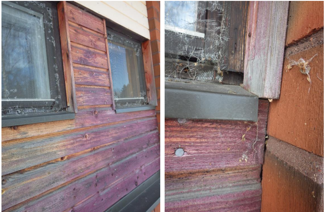
Kuva 31 a ja b. Yhteisien pesutilojen kohdalla on suunnitelmista poiketen kaksi pientä ikkunaa ja huonokuntoinen panelointi. Ikkunaliitoksia ei ole tiivistetty ja niissä on rakoja, joista on suora yhteys eristetilaan.
