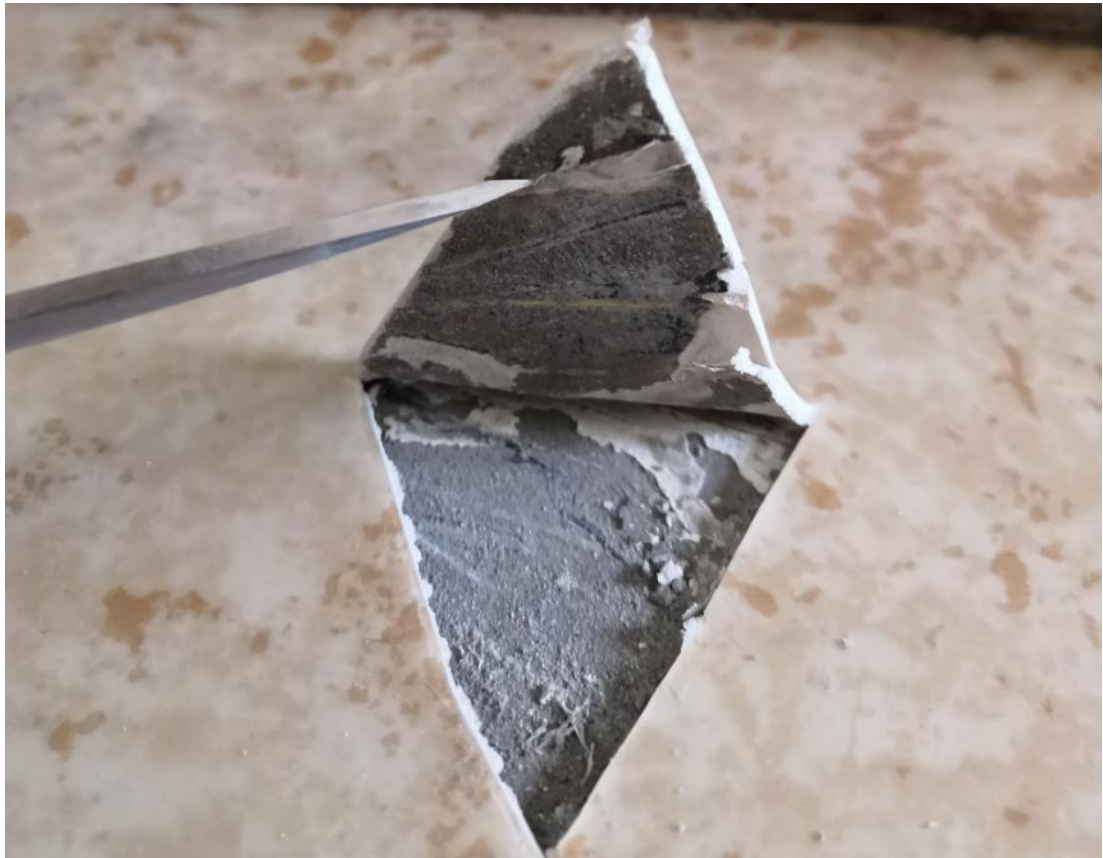
Kuva 21. V5, H001 wc-oven edusta, karmissa kosteusvaurio. Viiltomittauksen tulos 64,5 %RH. Maton tartunta alustaansa heikko, asennettu likaiselle tai pölyiselle alustalle, matto hieman kovettunut, heikko kemikaalimainen haju, ei värimuutoksia, murtopinta tasoitteessa.
