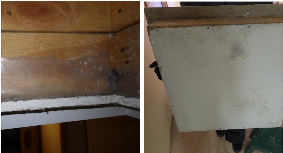
Kuva 57 a ja b. Yläpohjaan vievä luukku on tiivistämätön. Luukussa ja luukun päällä olevassa EPS-eristeessä havaittiin kosteusjälkiä. Aukkoon rajoittuvan kipsilevyn reunassa havaittiin pehmentymistä ja kosteusjälkiä.
