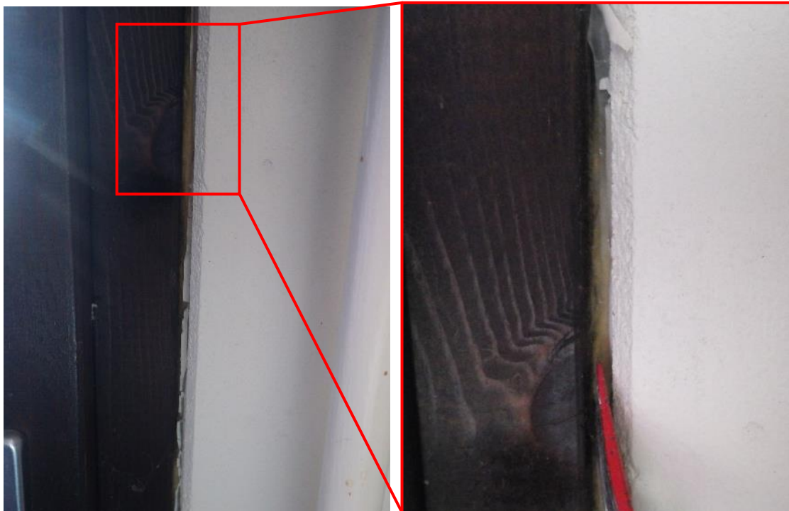
Kuva 32 a ja b. Tiivistämättömyydestä ikkunaliittymistä havaittiin aistinvaraisesti ja merkittävästi selvä ilmavuoto. Höyrynsulkumuovi on katkaistu sisäverhouslevyn kanssa samaan pintaan ja karmin vierestä näkyy lasivillatilke. Kuva tilasta KK025.
