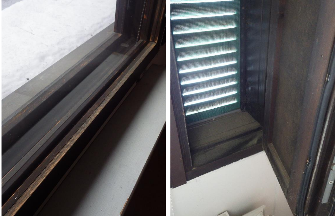
Kuva 33 a ja b. Ikkunoiden värillisellä puunsuoja-aineella käsitellyt osat ovat haalistuneet ja hilseilleet. Tuuletusikkunoiden välitiloissa havaittiin pölyä ja roskaa.
