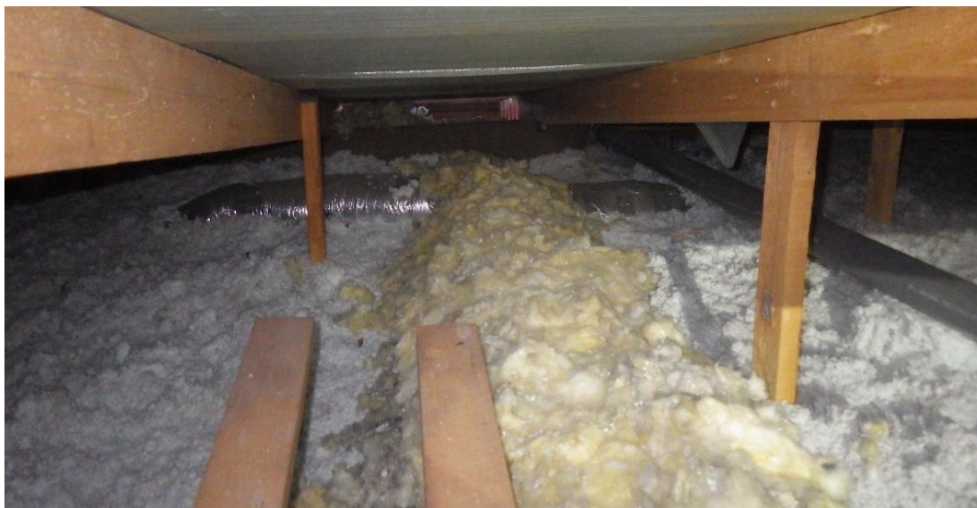
Kuva 65. Poistoilmakanavat on eristetty kanavaeristeillä ja paikoitellen kanavaeristeiden päälle on lisäksi asennettu lasivillalevyjä ja paloja.
