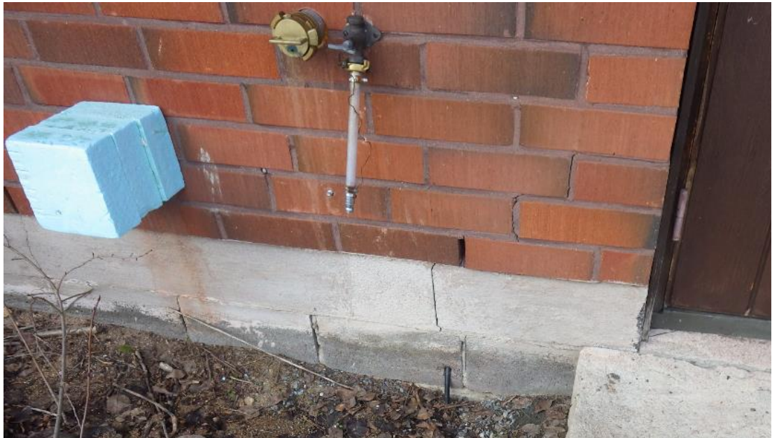
Kuva 27. Pohjoispäädyn oven vieressä havaittiin tiilimuurin ja sokkelin halkeilua. Sokkelin yläosassa tasoitus ja alempana saumat ovat näkyvillä. Tiilimuurauksen ilmaratot ovat aistinvaraisesti tarkasteltuna avonaisia.
