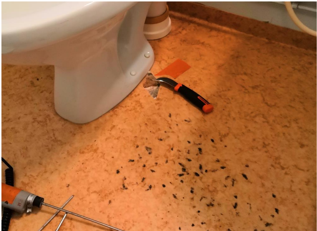
Kuva 39. Huoneen H009 wc-tilan muovimatossa havaittiin tummia jälkiä/likaa.
