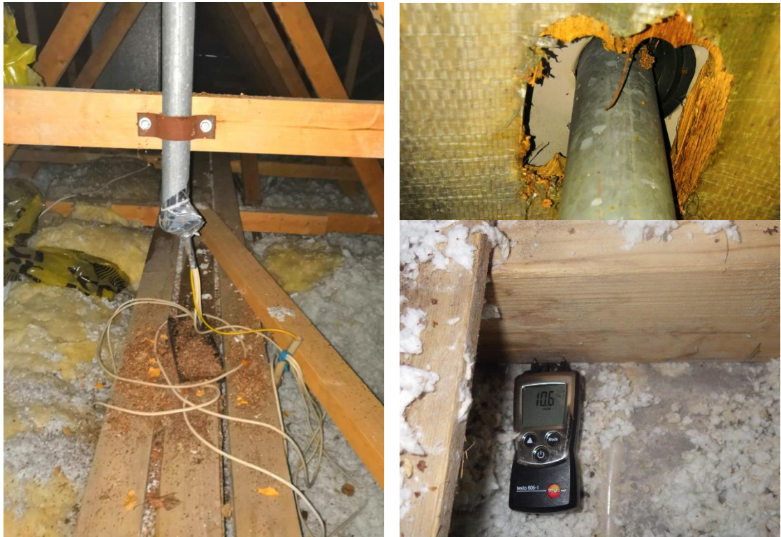
Kuva 51 a ja b. Antennitelineen liitoskohta harjalla on tiivistämättä, jonka seurauksena yläpohjatilaan kosteutta. Telineen kohdalla havaittiin kosteusjälkiä höyrynsulun päällä puhallusvillassa. Piikkikosteusmittauksen perusteella alapaarteen pinta on päässyt kuivumaan.
