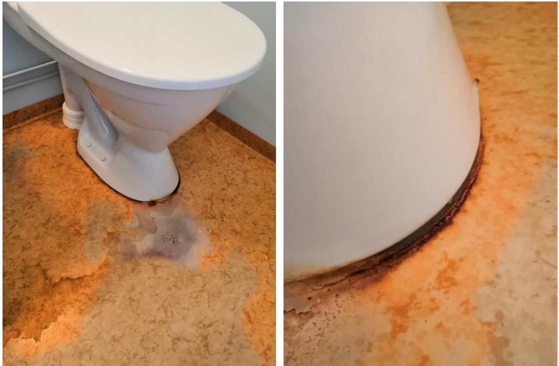
Kuva 40 a ja b. Huoneen H002 wc-tilan muovimatossa havaittiin runsaasti kosteusjälkiä, värimuutoksia ja kulumaa. Wc-istuimen liitoksen tiivistys oli vaurioitunut ja liitoksen vieressä havaittiin viitteitä muovimaton alle päässeestä kosteudesta.
