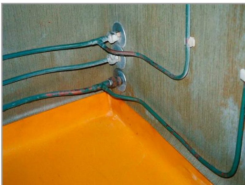
KUVA 12. Suihkunurkkauksen alaosassa olevat vuotavat vesijohtoputkien läpiviennit sekä vedeneristeenä toimivan muovitapetin puutteellinen kiinnitys. (Ympäristöopas 2016, 169; P. Laamanen, Vahanen Oy.)
