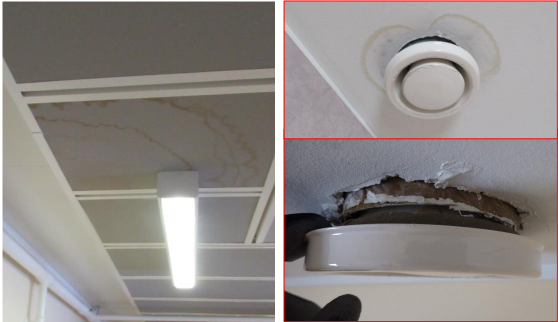
Kuva 61 a, b ja c. Huippuimurin kohdalla sisäkaton akustiikkalevyissä havaittiin kosteusjälkiä (kuva a). Poistoilmakanavien päätelaitteiden ympärillä havaittiin tiiviyspuutteita sekä kosteusjälkiä, jotka johtuvat todennäköisesti aiemmin eristämättömien kanavien pinnan kondenssista (kuva b ja c).
