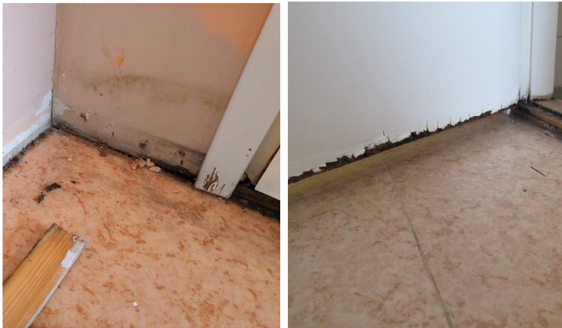
Kuva 37 a ja b. Huoneen H001 wc-tilan kynnyksen vasemmalla puolella havaittiin kosteusvaurio ja kosteusjälkiä levyssä (kuva a). Oven alareuna oli vaurioitunut (kuva b).
