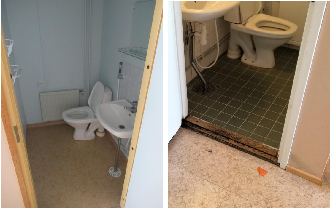
Kuva 38 a ja b. Yleiskuva muovimatolla ja maalilla pinnoitetusta wc-tilasta (kuva a). Yleiskuva laatoitetusta wc-tilasta (H001), kynnyks vaurioitunut (kuva b).
