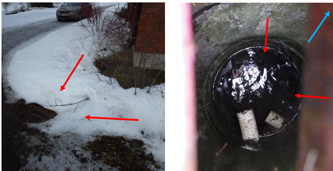
Kuva 6 ja b. Luoteisnurkan sadevesikaivoon liittyy kaksi valkoista ja kaksi mustaa salaojaputkea, mustat putket tulevat rakennuksen suunnalta ja valkoiset piha-alueelta. Kuvissa sininen nuoli kuvaa talon nurkan suuntaa kaivoon nähden ja punaiset nuolet mustien salaojaputkien tulokulmaa. Mikäli mustat putket ovat rakennuksen salaojia, ne eivät toimi tarkoituksenmukaisesti, koska ne ovat kaukana sokkelilinjasta sekä vedenpinnan alapuolella.
