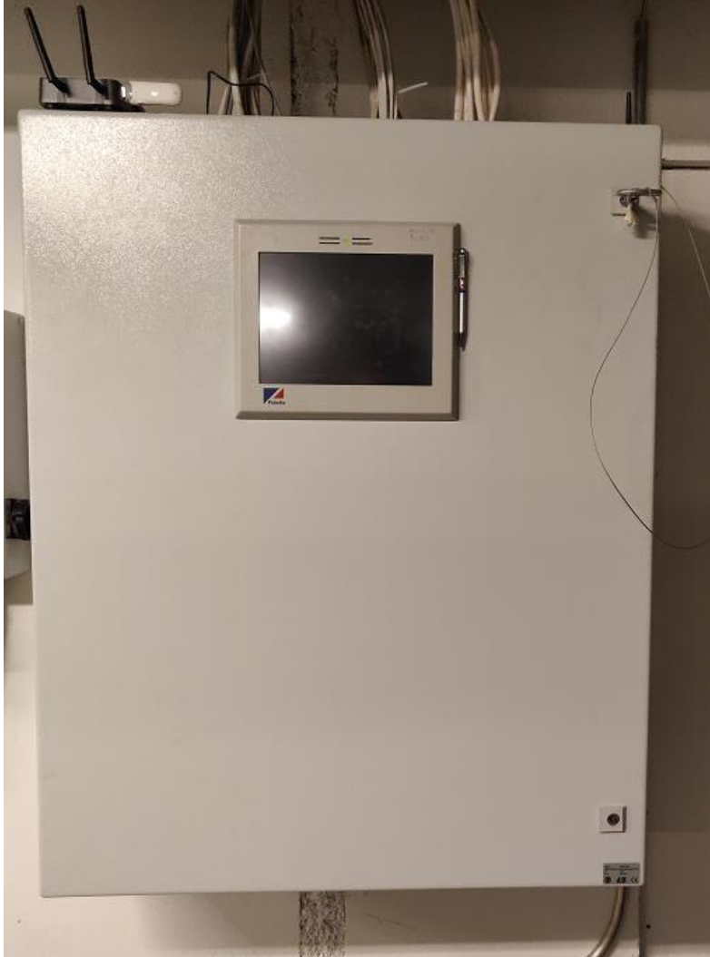
Kuva 3. Graafisella käyttöliittymällä varustettu valvonta-alakeskus.
