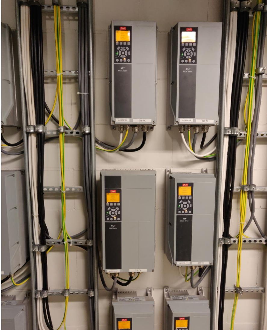
Kuva 7. Rakennusautomaatioon liitettyjä IV-koneiden taajuusmuuttajia.
