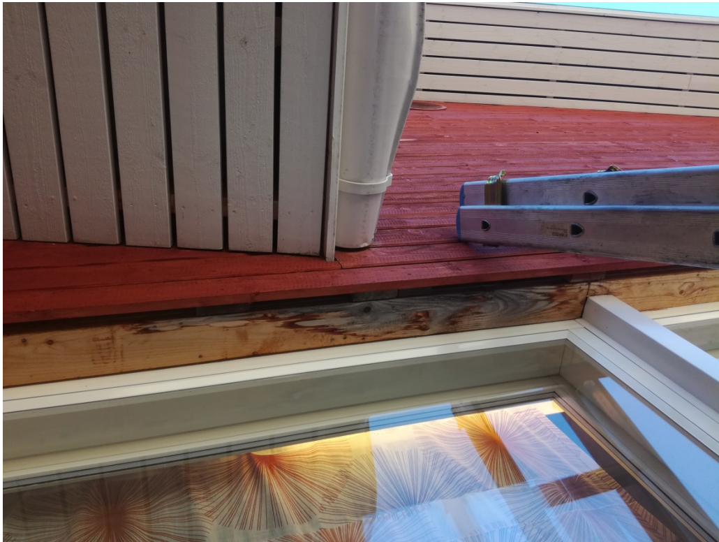
Kuva 6: Rästäs on vääntynyt yhdyskäytävän yläpuolella ja ikkunan yläpuolinen lauta on jätetty maalaamatta
