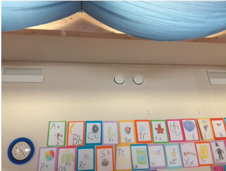
Kuva 12. Alkuperäisen osan tulo- ja poistoilmanvaihto elimet lähekkäin toisiaan.
