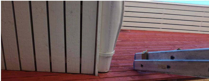
Kuva 9. Vääntynyt räystääs tulee korjata tai tarvittaessa korvata uudella.
