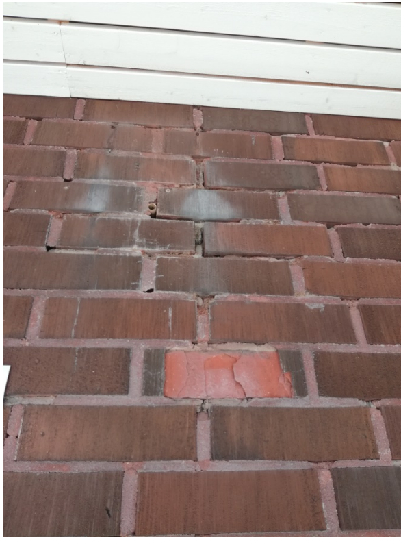
Kuva 8: Toimiston ulkoseinässä tiilen ja saumalaastin lohkeamia
