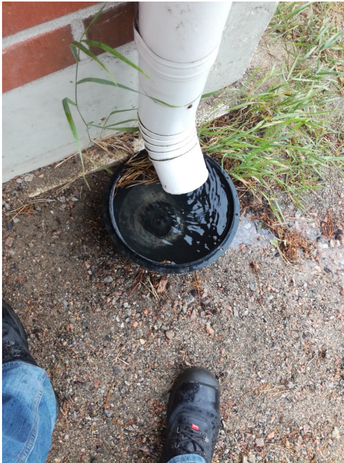
Kuva 4: Uuden rakennuksen nurkalla räystääskaivo ei toimi asianmukaisesti, koska putki on täynnä hiekkaa
