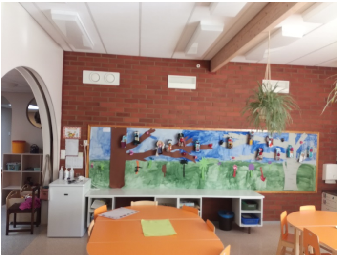
Kuva 14: Ryhmätilan vierekkäin asennetut poisto- ja tuloilma kanavat
