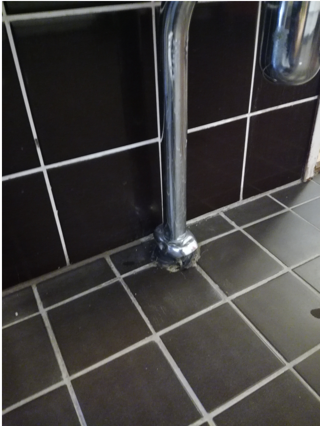
Kuva 13. Huonosti tiivistetty pesualtaan viemäröinti.
