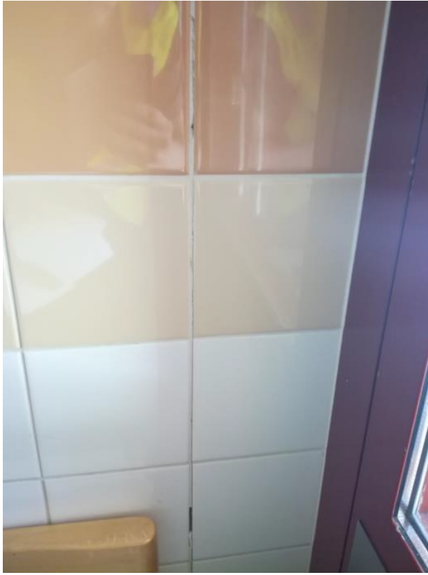
Kuva 4. Laajennusosan eteisen lohkeillut saumalaasti.
