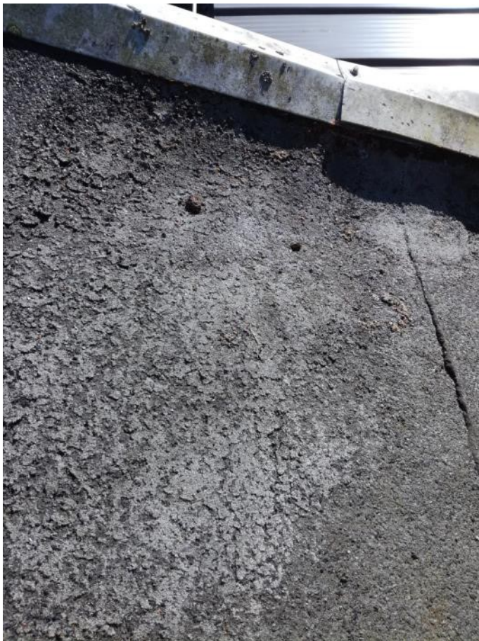
Kuva 6. Alkuperäisen osan vesikatto. Bitumin pinta on kulunut ja saumat ovat repeilleet veden jäätyessä.
