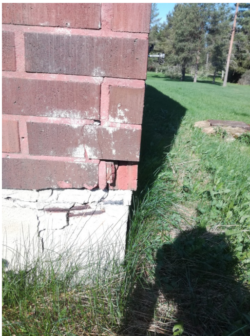
Kuva 7: Vanhan rakennuksen sokkelissa on halkeama koillisnurkassa. Ulkoseinä-rakenne on aikansa mukainen, eli seinässä ei ole tuuletusrakoa.
