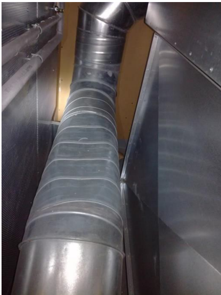
Kuva 11. Kolhiintunut ilmanvaihtokanava konehuoneessa.
