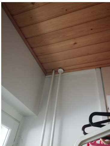
Kuva 15: Putkien läpivienti renkaita puuttui rakennuksessa sieltä täältä
