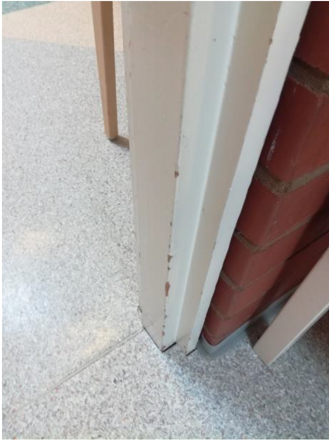
Kuva 2. Kulumaa alkuperäisen osan oven karmeissa.
