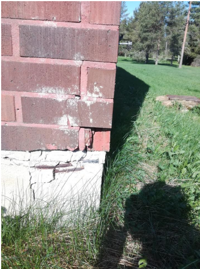
Kuva 8. Alkuperäisen osan sokkelista on lohjennut pala ja harjateräksset ovat alttiina kosteudelle.
