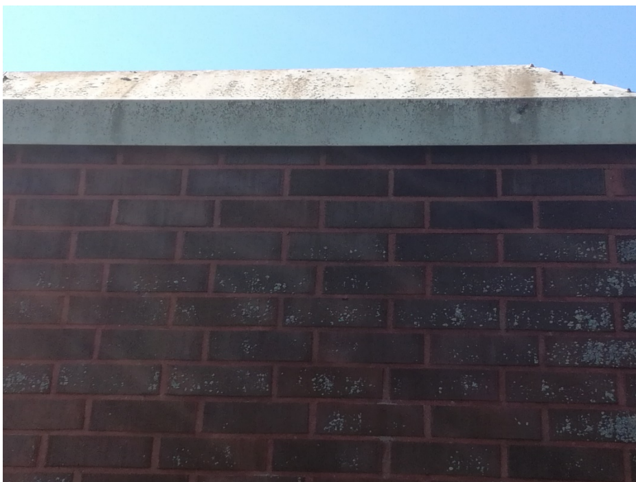
Kuva 10: Vanhan osan katon pellit ja julkisivu ovat keränneet sammalta ja likaa
