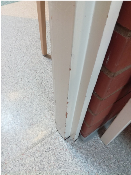
Kuva 1: Oven karmeissa etenkin vanhalla puolella kulumisen jälkiä
