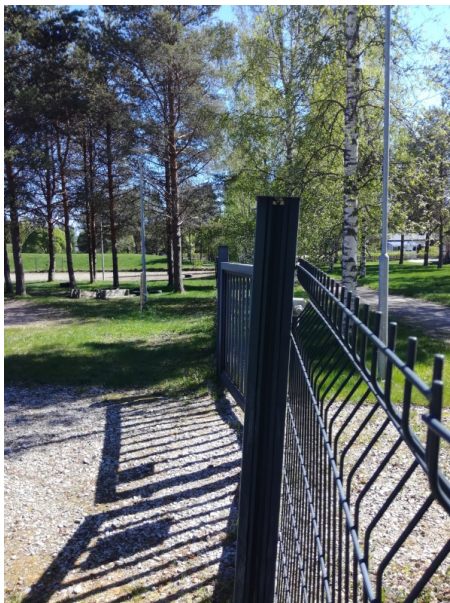
Kuva 5: Porttitolppa eteläpuolella on päässyt nurjahtamaan
