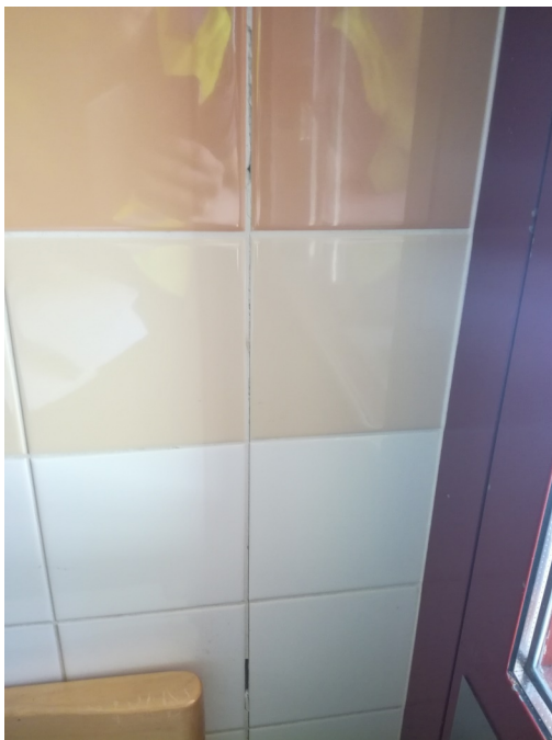
Kuva 2: Uuden puolen eteisen oven vieraista laatoista saumalaastia on paikoin irronnut
