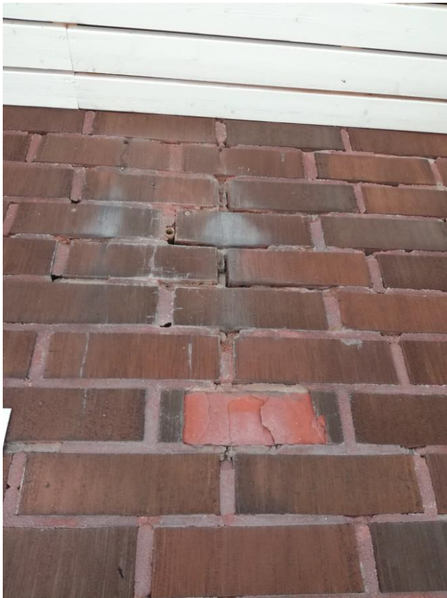
Kuva 5. Alkuperäisen osan julkisivutiilet ja saumauslaasti ovat lohkeilleet useasta kohdasta.
