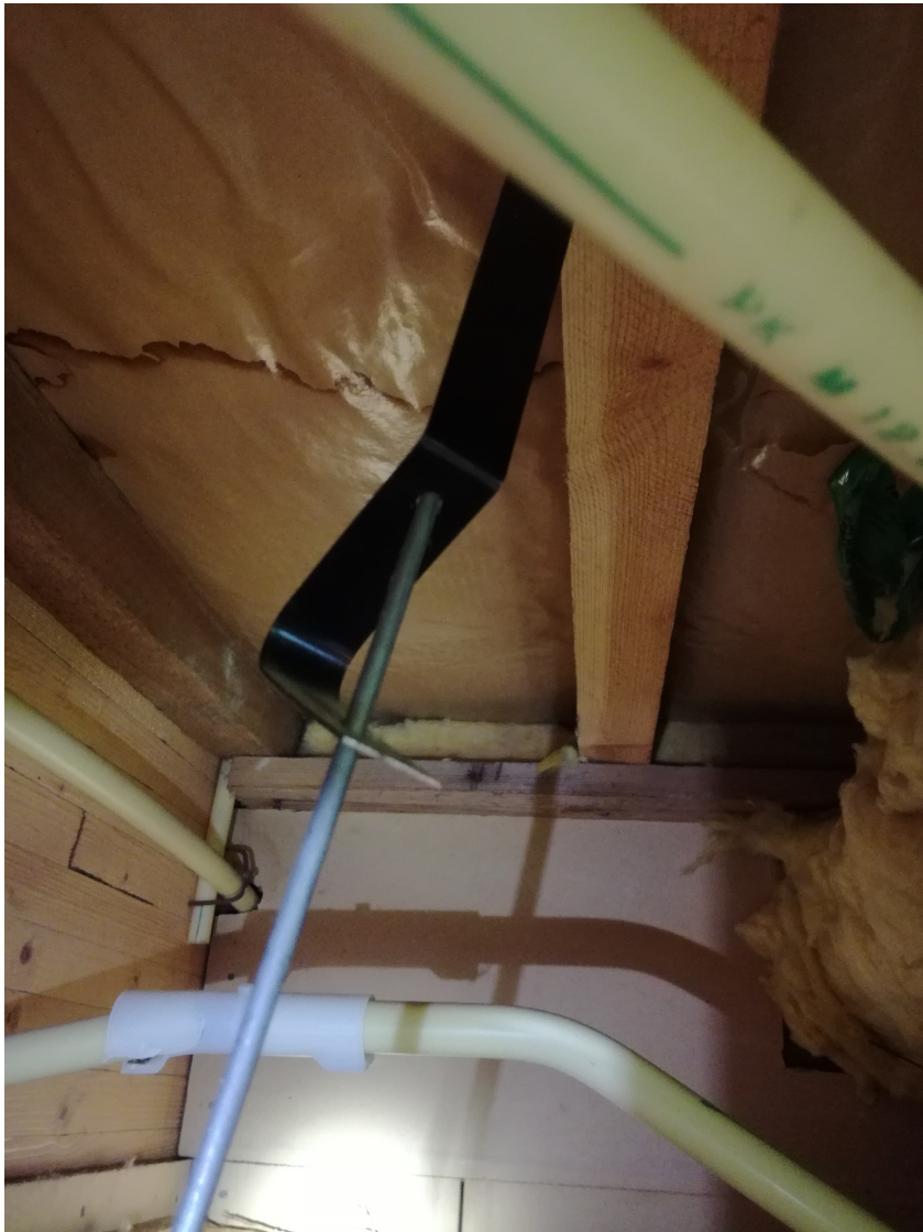
Kuva 7. Höyrynsulkupahvista löytynyt kosteusjälki.
