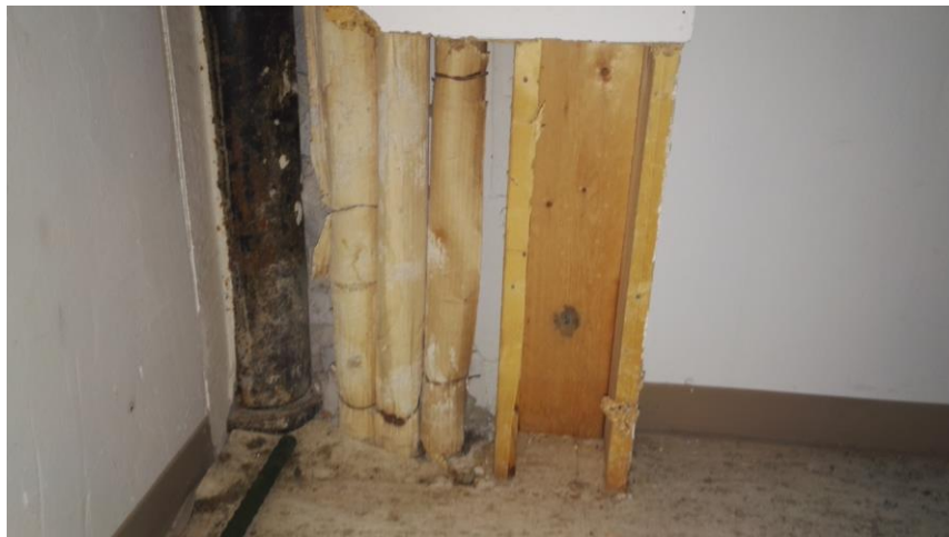
Kuva 2. Asbestia sisältäviä vanhoja putkieristeitä. Lähde, Sisäilmatalo Kärki Oy, arkisto
