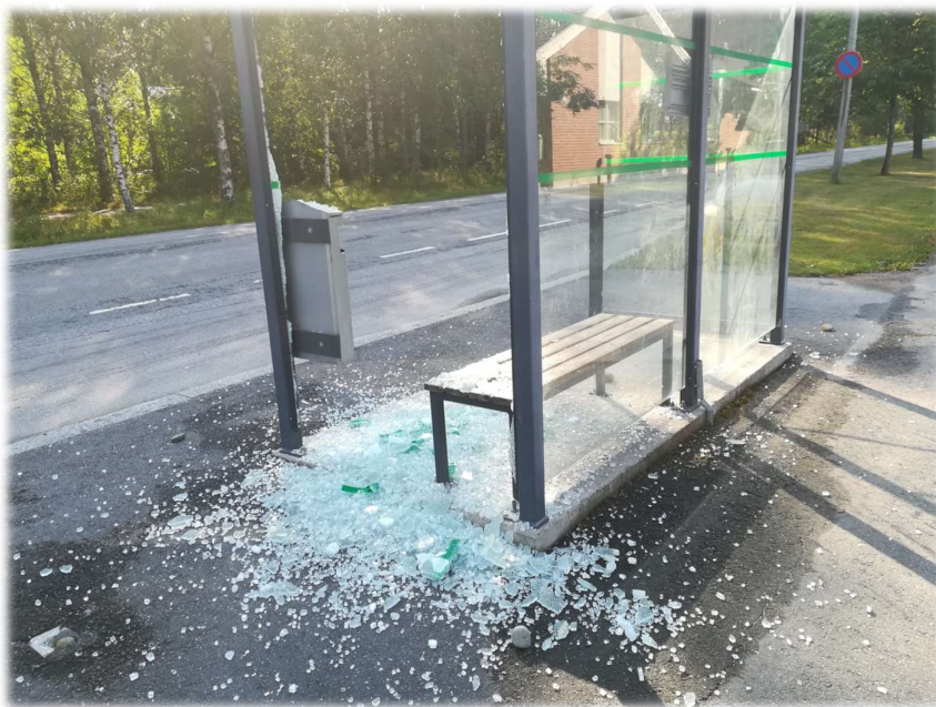
Kuva 23. Linja-autokatoksen lasipaneeli rikki Kråklundissa (Kuva: Antila).
