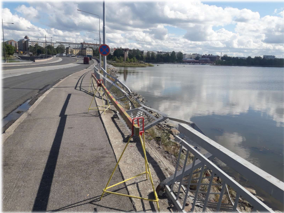
Kuva 26. Vaskiluodon sillankaide (Kuva: Lähteenmäki).
