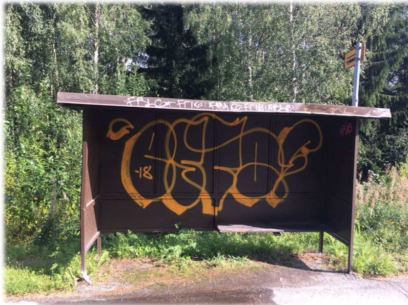
Kuva 21. Töhritty linja-autokatos (Kuva: Etelämäki).
