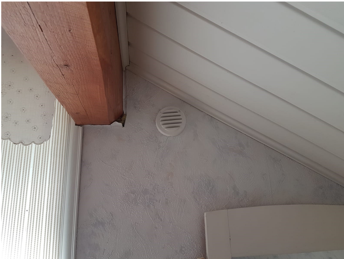
Yläkerran jokainen makuuhuone sisältää venttiilin 75x75.
