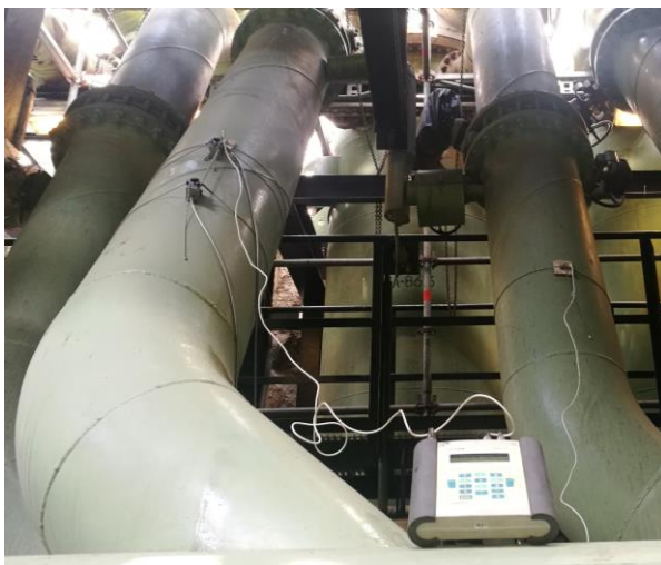
Kuva 7. Tehomittauksen laitteisto asennettuna mittauskohteeseen.
