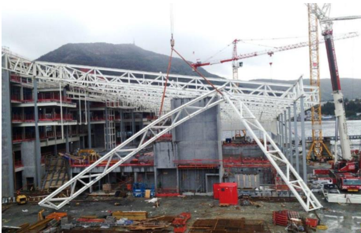
Figur 1. Ett exempel på vad som kan hända ifall man lyfter ett fackverk på fel sätt. I detta fall har man fått tryckkraft i underramen som endast ska ta dragkraft och därav har knäckning inträffat med kollaps som följd. Detta är ofta ett problem som behöver beaktas vid slanka konstruktioner. Fackverket på bild har en spännvidd på över 40 m. (Ruukki Powerpoint om stålbroars montageprinciper)
