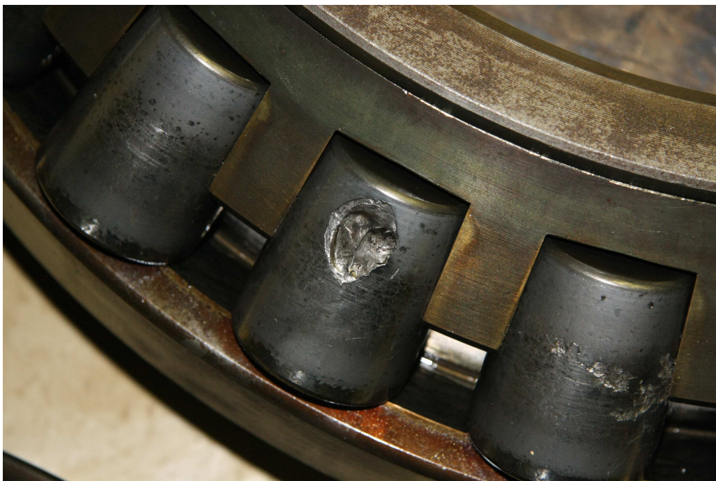
Kuva 11. Aksiaalilaakerin kartiorullat laakerivauriossa Kyrkösjärven voimalaitoksella
