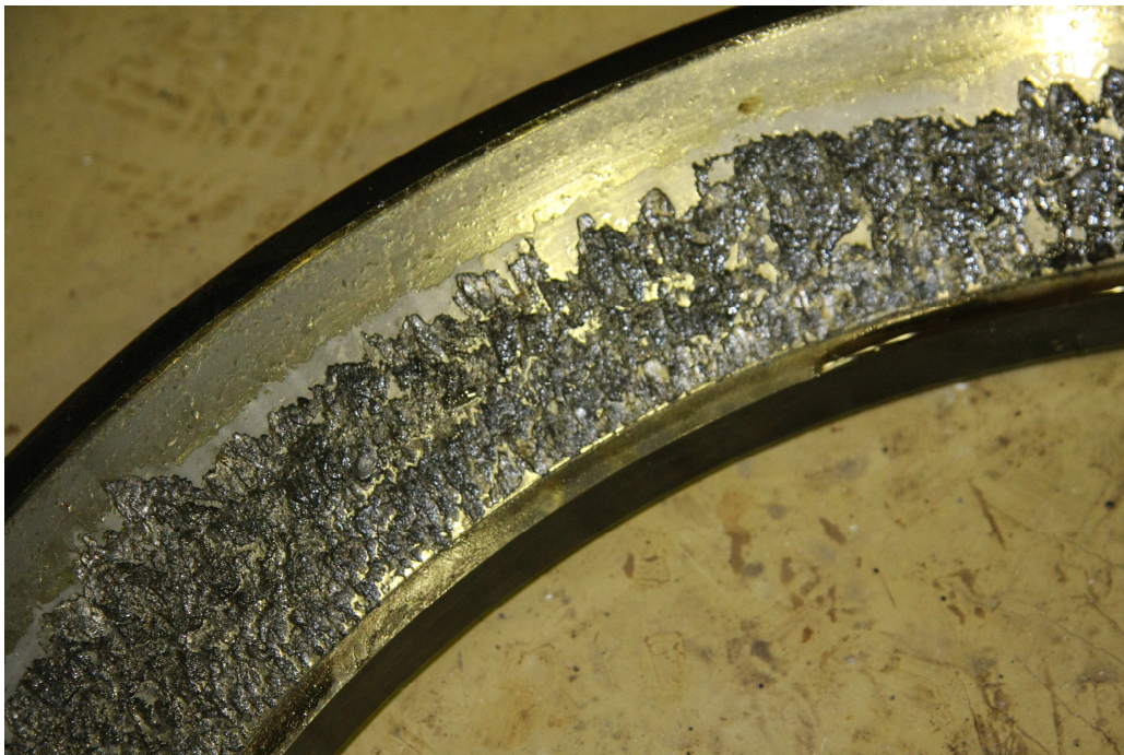
Kuva 12. Aksiaalilaakerin liukupinta laakerivauriossa Kyrkösjärven voimalaitoksella
