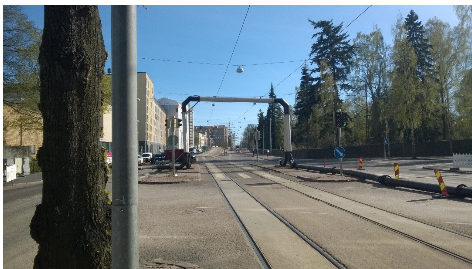
Kuva 4. Mechelininkadun sekavesiviemärin ohipumppausputken sijoittuminen raitiotieradan yhteyteen siten, että liikennöinti radalla oli mahdollista (Leppänen 2016).
