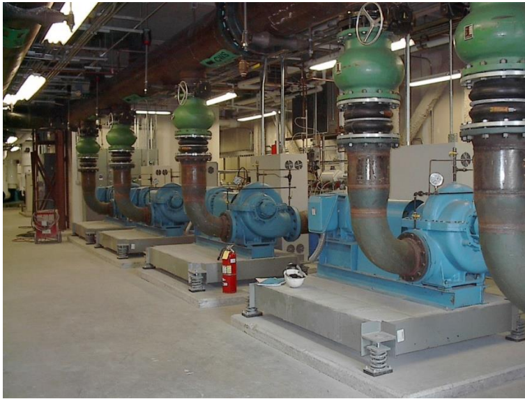
Kuva 25. Jousivaimennetun inertia-lohkon päälle asennettuja koneita (Total Vibration Solutions 2019.)
