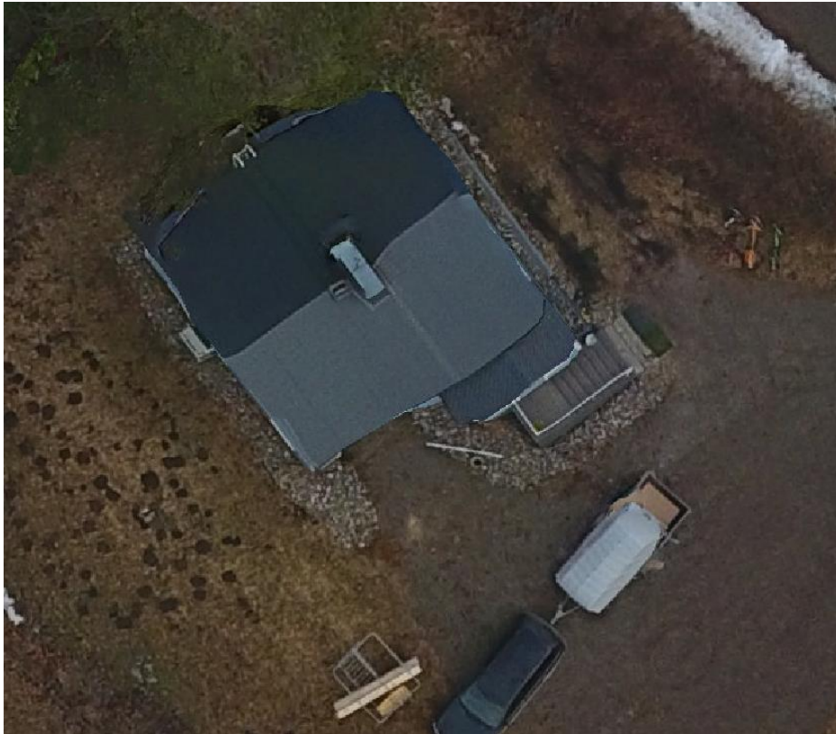
Kuva 7. Rakennuksen vääristynyt räystäslinja
