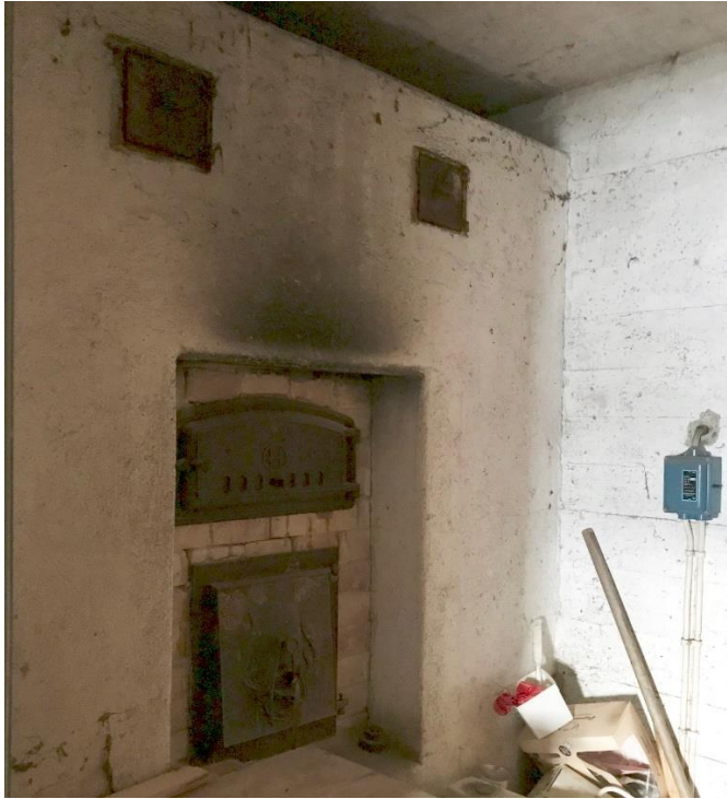
Kuva 9. Antti-uuni on asuinrakennuksen alkuperäinen lämmitysjärjestelmä.
