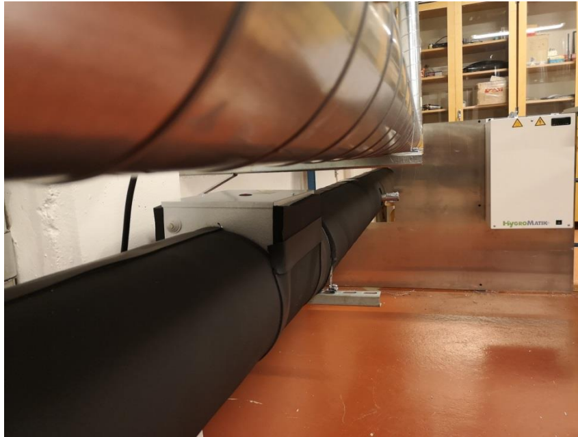
Figur 27. Tilluftskanalen utifrån aggregatet. Elektriska värmaren visas och i bakgrunden kan man se ångspjutet och befuktningseenheten.
