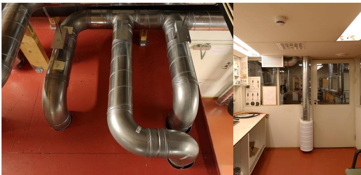
Figur 30. Tilluftskanalerna på taket (Vänster) som går till de olika donen inne i kontrollrummet (Höger). Donen från höger till vänster Lockzone, Eagle, DHC och EXC (Frånluft).
