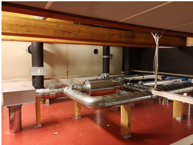
Figur 32. Frånluftskanalerna uppe på taket.
