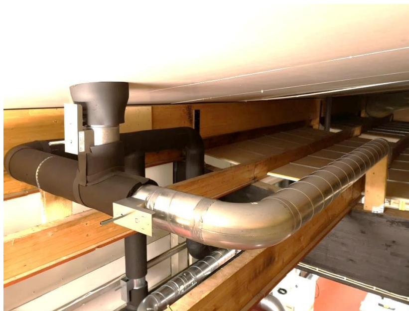
Figur 24. Avluften med valmöjlighet att leda utomhus eller till maskinhallen. Blandningskanalen samt kanalen till aggregatet i bakgrunden.
