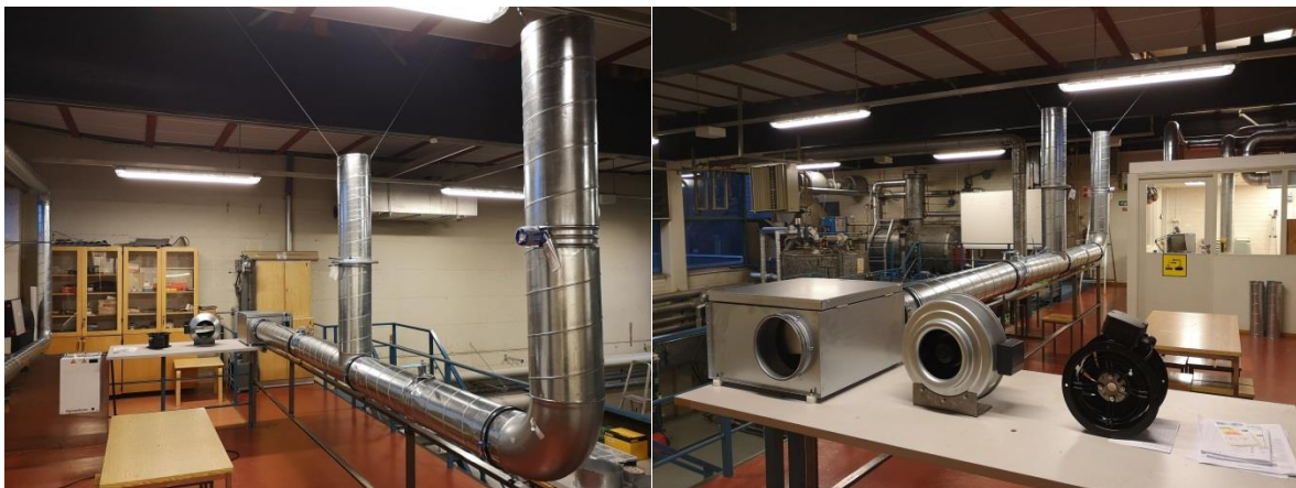
Figur 40. Fläktsystemet med de olika spjällen samt fläktarna.
