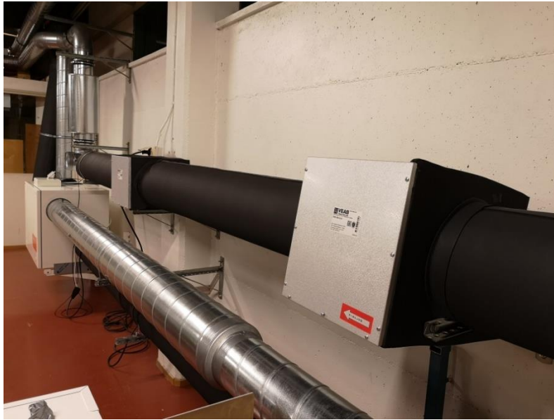
Figur 28. Tilluftskanalen efter ångspjttet med den vinkelmonterade kylaren samt värmaren. I bakgrunden visas ljuddämpningen.
