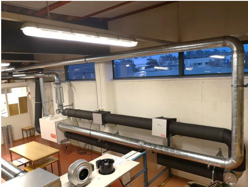
Figur 33. Frånluftskanaln med den långa kanalen.
