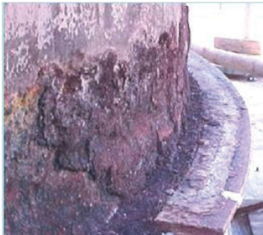
Kuva 4. Eristeen tukirenkään CUI-vaurio. (API Recommended Practice 583 Corrosion Under Insulation And Fireproofing 2014, 17.)
