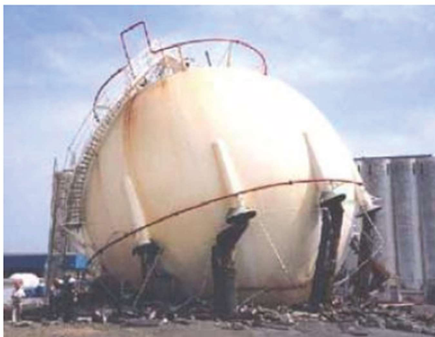
Kuva 5. Pallosäiliön luhistuminen CUI-vaurion vuoksi. (API Recommended Practice 583 Corrosion Under Insulation And Fireproofing 2014, 17.)
