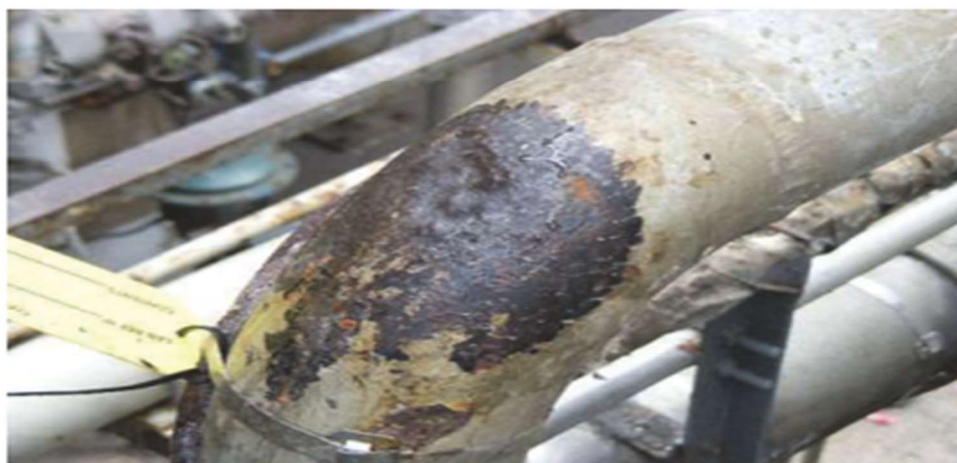
Kuva 3. Eristetty putkisto, jonka eristevaipan vauriosta vesi pääsee imeytymään eristeen läpi (yläkuva), aiheuttaen eristeen alla olevan putken korrodoitumista (alempi kuva). (API Recommended Practice 583 Corrosion Under Insulation And Fireproofing 2014, 14.)
