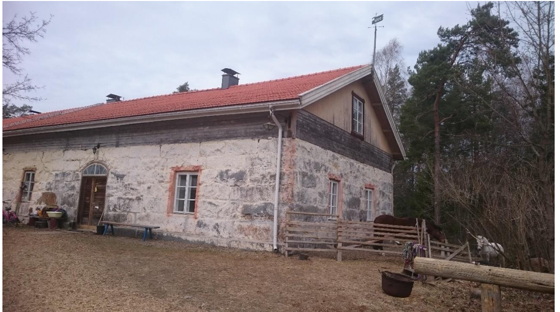
Kuva 20. Päärakennuksen päätykuvasta näkee rakennuksen päätyikkunan ylhäällä, josta voitaisiin rakentaa portaat mahdolliseen majoitustilaan. (Anttonen 2019)
