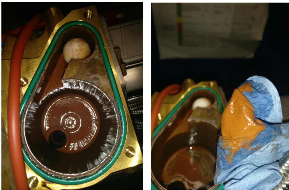
Kuva 13 Temperointilaitteen tuloveden likaantunut venttiililohko
