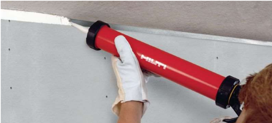
KUVA 2. Akryylipohjainen palokatkomassa (CFS-S ACR Akryylipohjainen palokatkomassa. 2019.)
