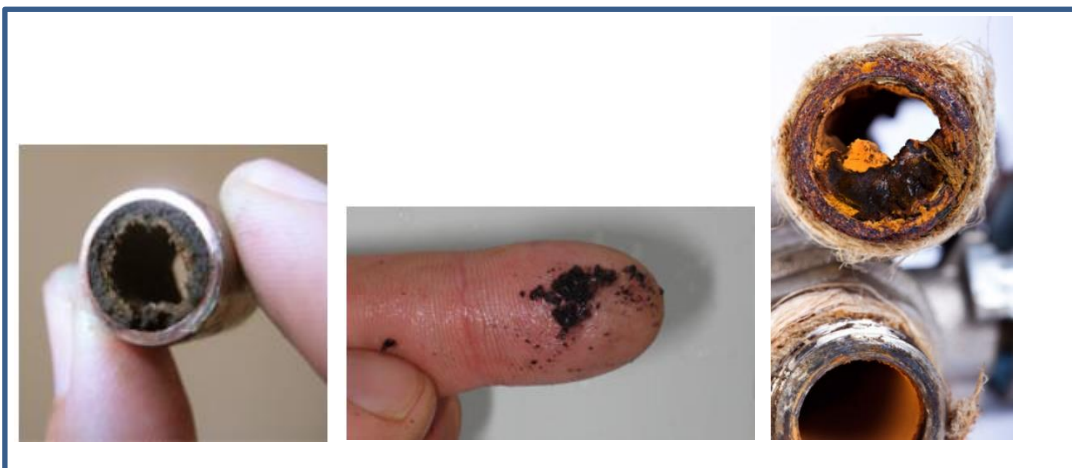
Kuva 6. Kerrostumaa ja sakkapartikkeleita. (Lämmönhuolto 2019).
