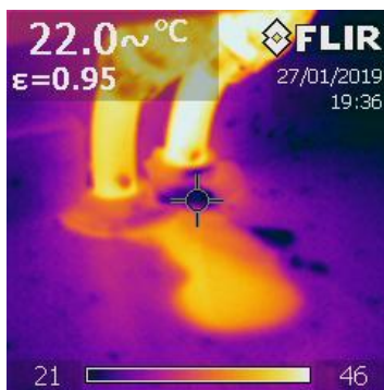
Kuva 22. Vuoto patterin kytkentäputkessa. (Petri Salmi).
