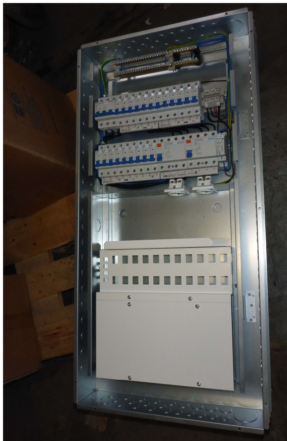
Figur 6. Bild av gruppcentralerna som användes vid radhusprojektet.
