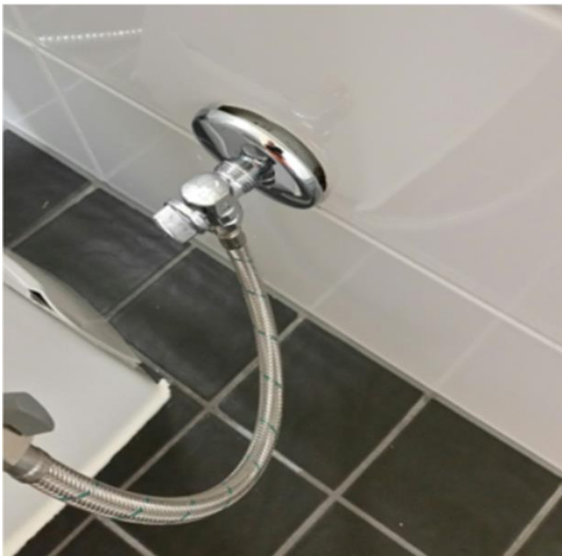
KUVA 9 Hanakulma on jätetty kiinnittämättä seinän sisällä, jonka takia se pääsee heilumaan ja on epäsiistin näköinen (1).
