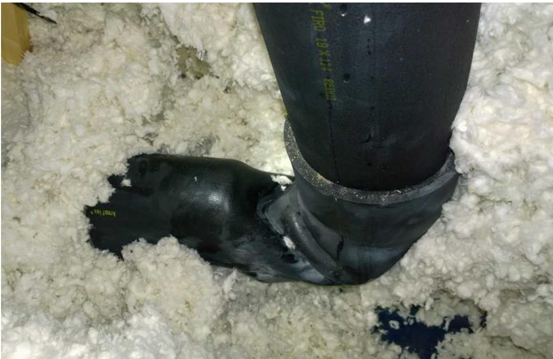
KUVA 7 Kohteessa ullakolla oleva viemärin tuuletusputki kannakoitu puutteellisesti, minkä takia liitos irronnut ja vesi valunut ullakolle ja sitä kautta kastellut kattopaneelit (1).
