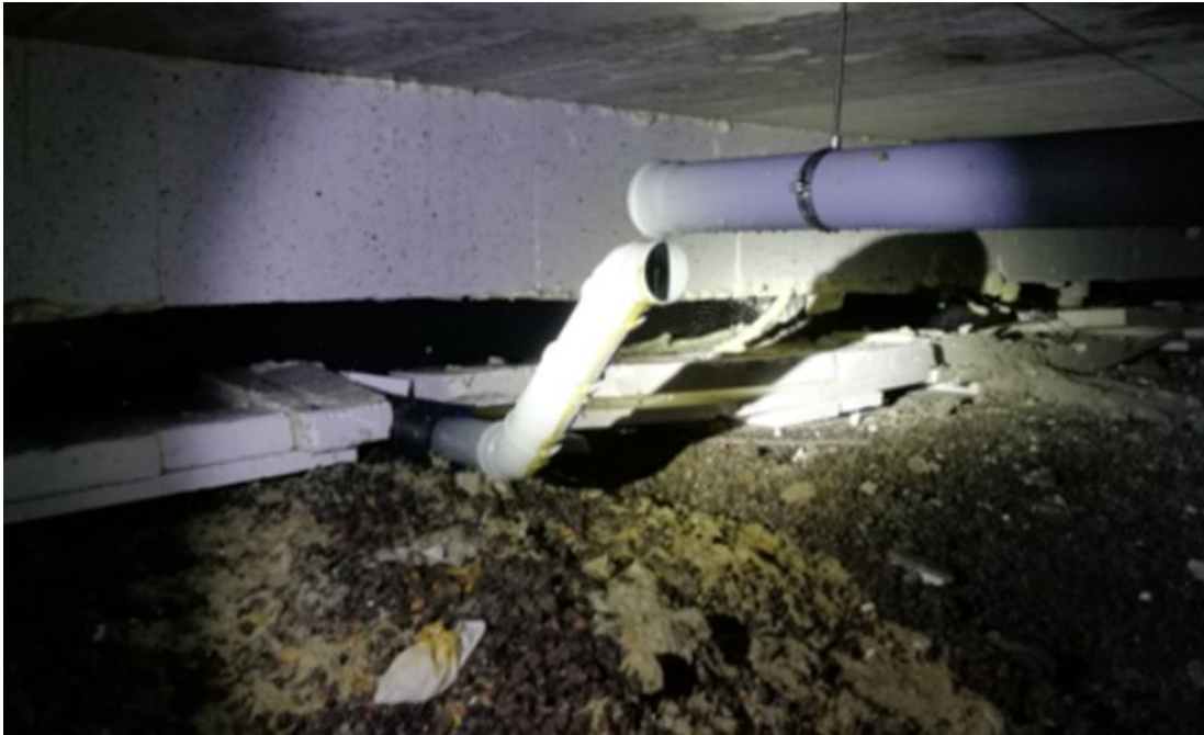
KUVA 8 Alapohjan viemäröinti kannakoitu virheellisesti, minkä takia liitos irronnut ja jäteväettä valunut alapohjaan (1).
