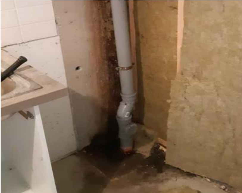
KUVA 6 Luhtitalokohteessa yläkerran keittiön viemäriputki oli jäänyt irti liitoksesta, minkä takia vesi vuotanut noin 2 vuotta kotelon sisään ja seinärakenteisiin (1).
