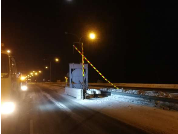
KUVA 36. Mittaportti ajettu rikki 21.2.2019
