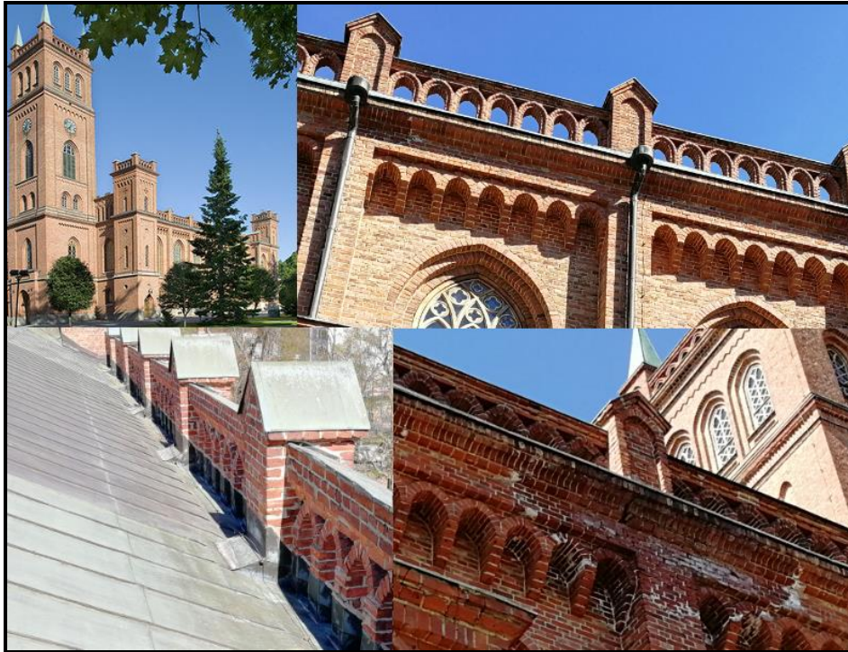
Kuva 1. Vaasan kirkko ja kosteusvaurio räystäään alla /9/.
