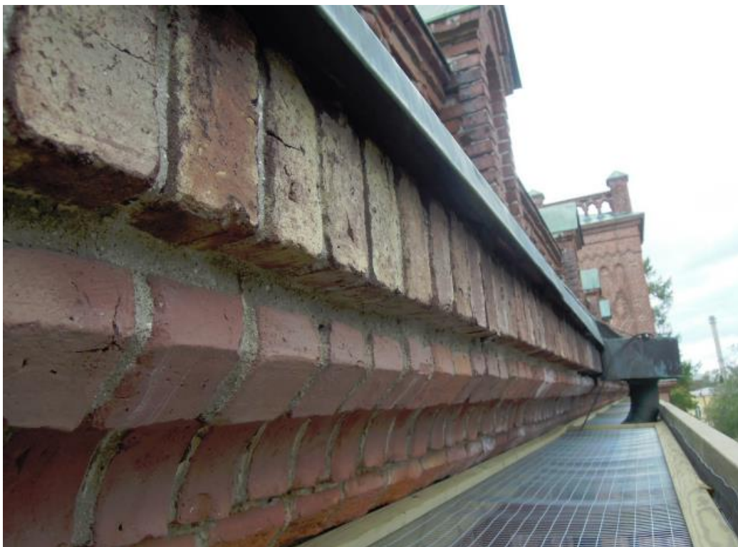
Kuva. Vaurion alle on asennettu vuonna 2018 suojaverkko, mikä estää tiili ja laasti palojen tipahtelemisen alla olevalle kulkureitille.
