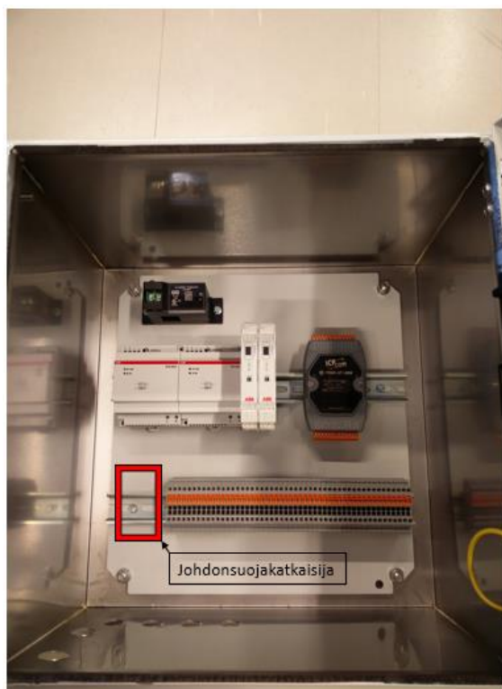
Kuva 36. CoreTec 4-ohjauskaapin sisältö.
