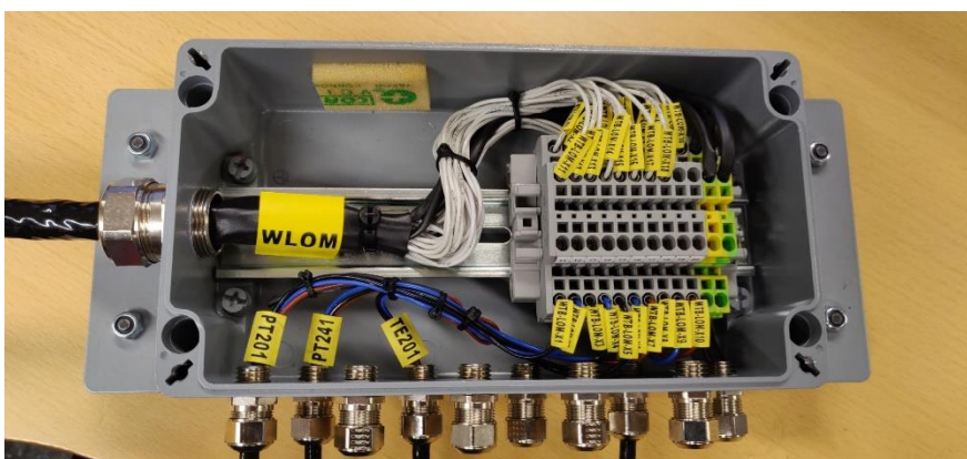
Kuva 22. Voiteluöljymoduulin valmis kytkentäkotelo.
