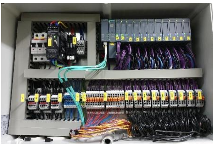
KUVA 3. Energianmittauskeskus (Anni Meiseri)
