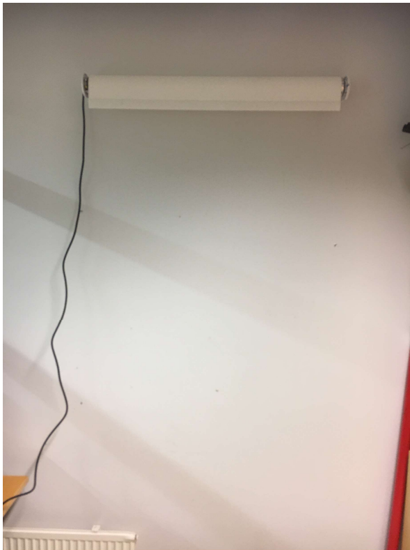
Kuva 29. Moottoroitu screenkaihdin yläasennossa talotekniikanlabran sivutilassa.
