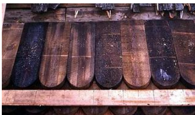
Kuva 92 – Hattulan Pyhän Ristin kirkon tervattuja paanuja vuodelta 1979 (Kuva: Hattulan Rakennus ja Kattotyö)
