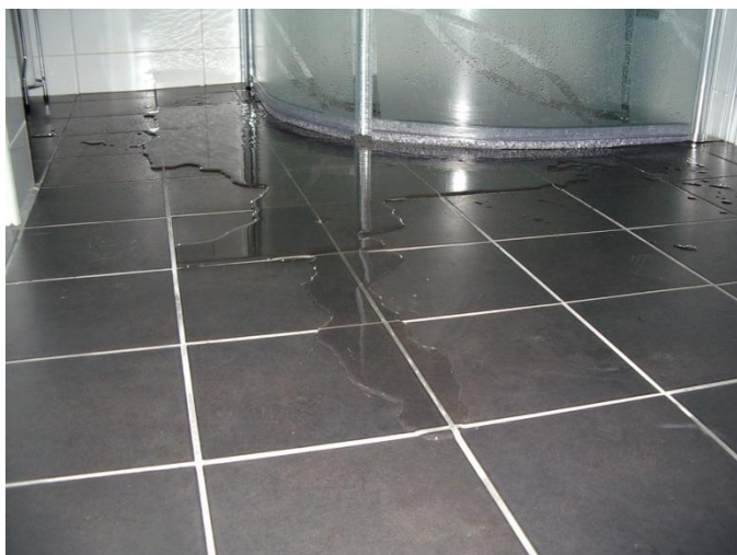
Bild 6. Vattensamling på grund av felaktig golvlutning, familjen-gustafsson.se
