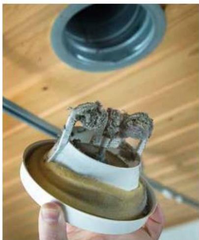
Bild 20. Ventiler skall tas löst och rengöras, Hengitysliitto.fi
