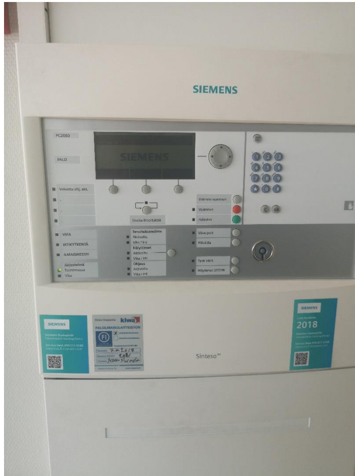
Kuva 2. Paloilmoitinkeskus Pulkamontien terveyskeskuksessa.
