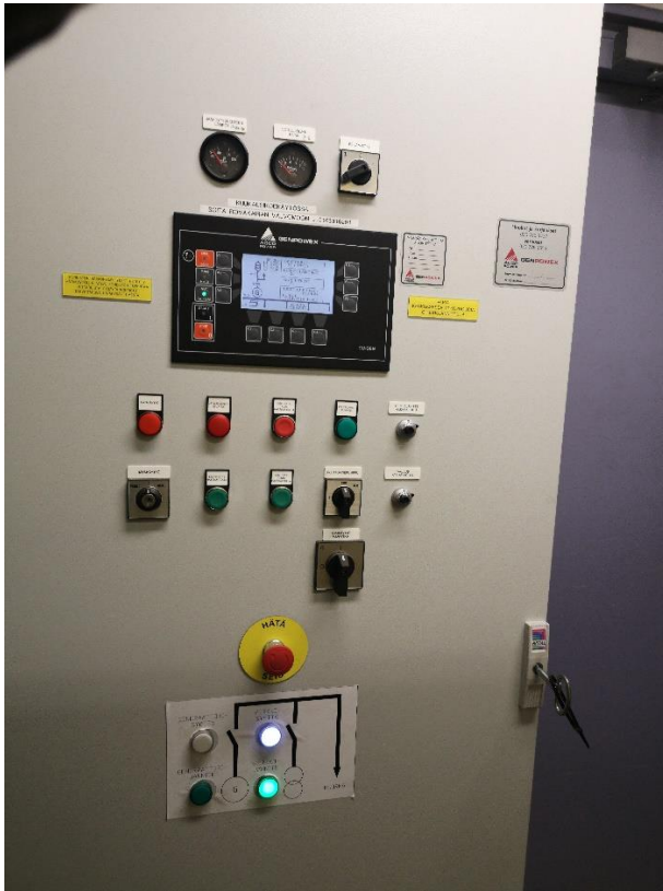
Kuva 1. Varavoimakoneen ohjaus- ja valvontakojeisto.
