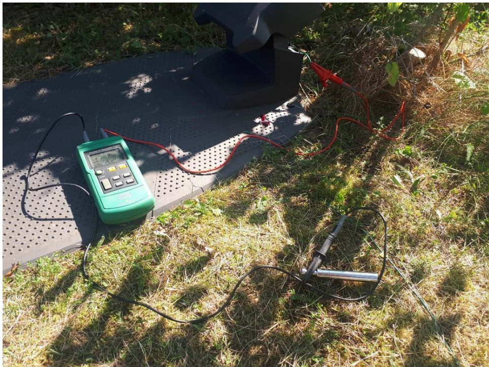
Kuva 44. Mittalaitteen kytkennät katkenneen kaapelin etsintää varten (Salo, 2018).
