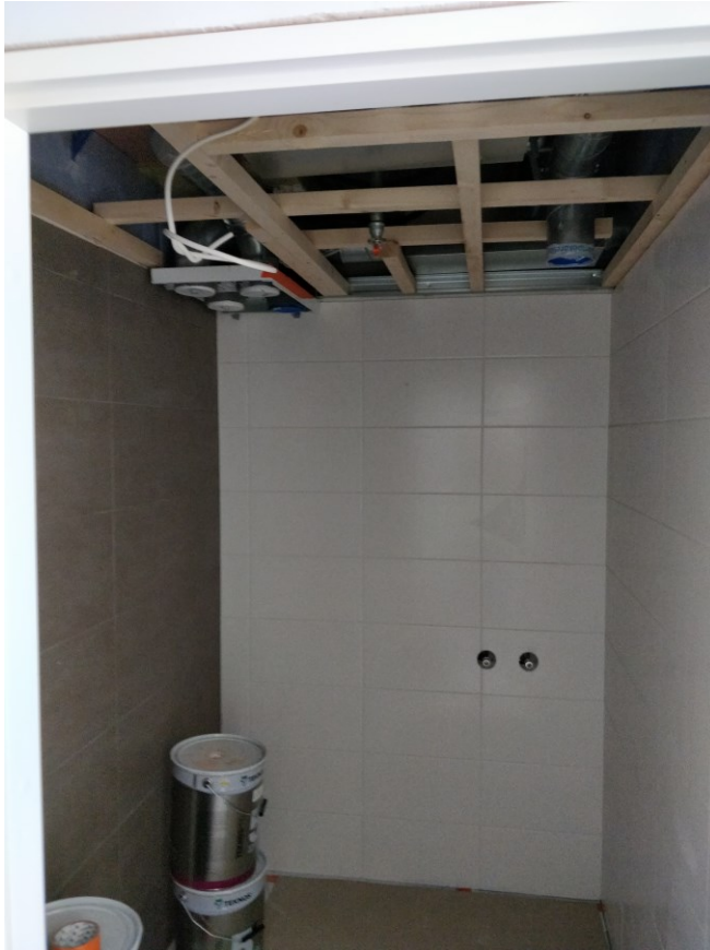
Kuva 17. WC-tilojen kattojen alaslaskujen levytykset puuttuvat.
