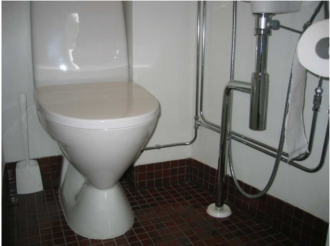
Kuva 13. Putki- ja laatoitustyön jälki.
