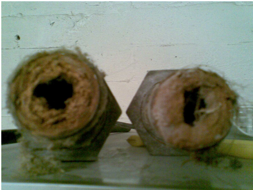
Kuva 6. Purettujen runkovesilinjaputkien korroosiokertymät.
