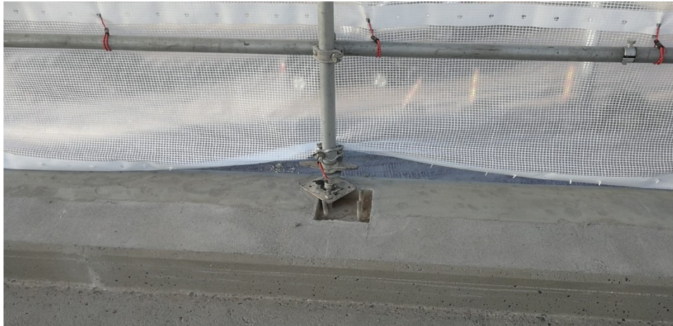
Kuva 14. Sääsuojan seinä liian lyhyt ja lisäksi jokaisen kiinnityslenkin kohdalla on pressussa reikä. Reunapalkin ja seinän välistä pääsee vettä kannelle.
