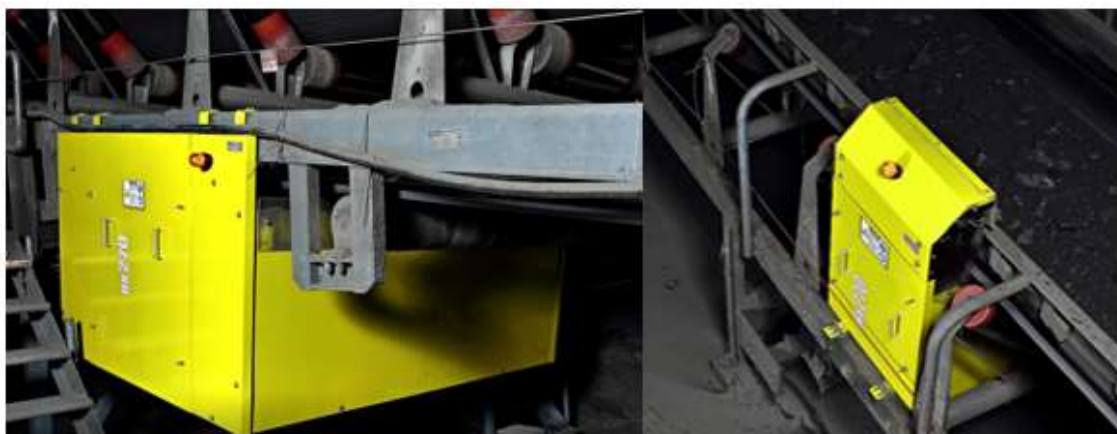
Kuva 1. Kuljetinhihnan materiaali- ja puhtaanpuolen kunnonvalvontalaite
