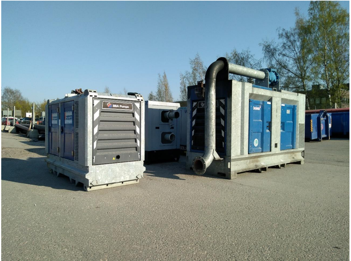
Kuva 2. Dieselmoottorilla varustettuja pumppuyksiköitä
