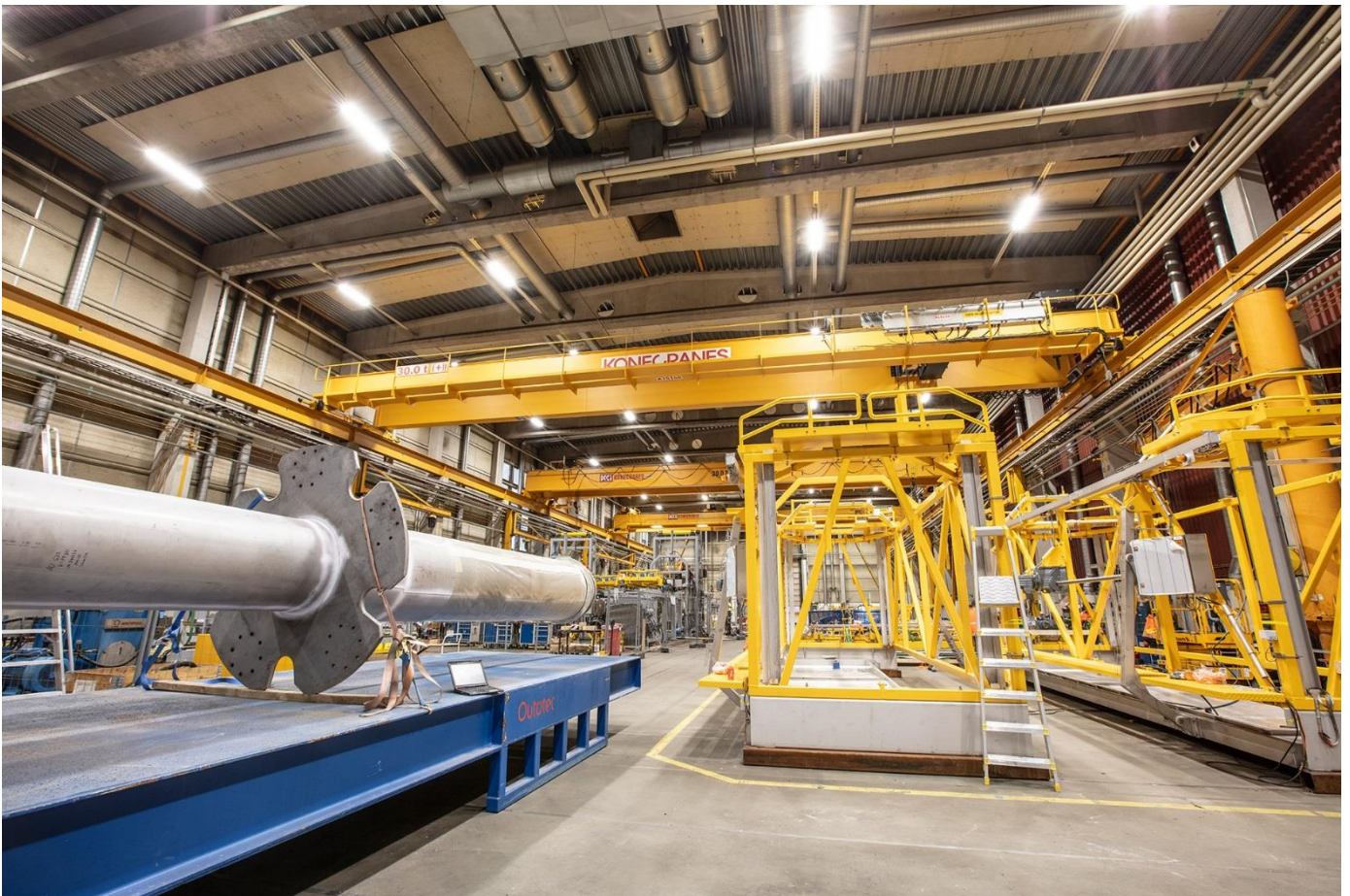
KUVA 14. Uusi valaistus kohteessa (Greenled 2019a.)
