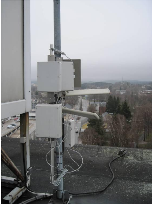
Kuva 5: Meriniitynkameroiden vastaanottoantennista, joka on sijoitettu Salon keskustassa olevan viljasiilon katolle.
