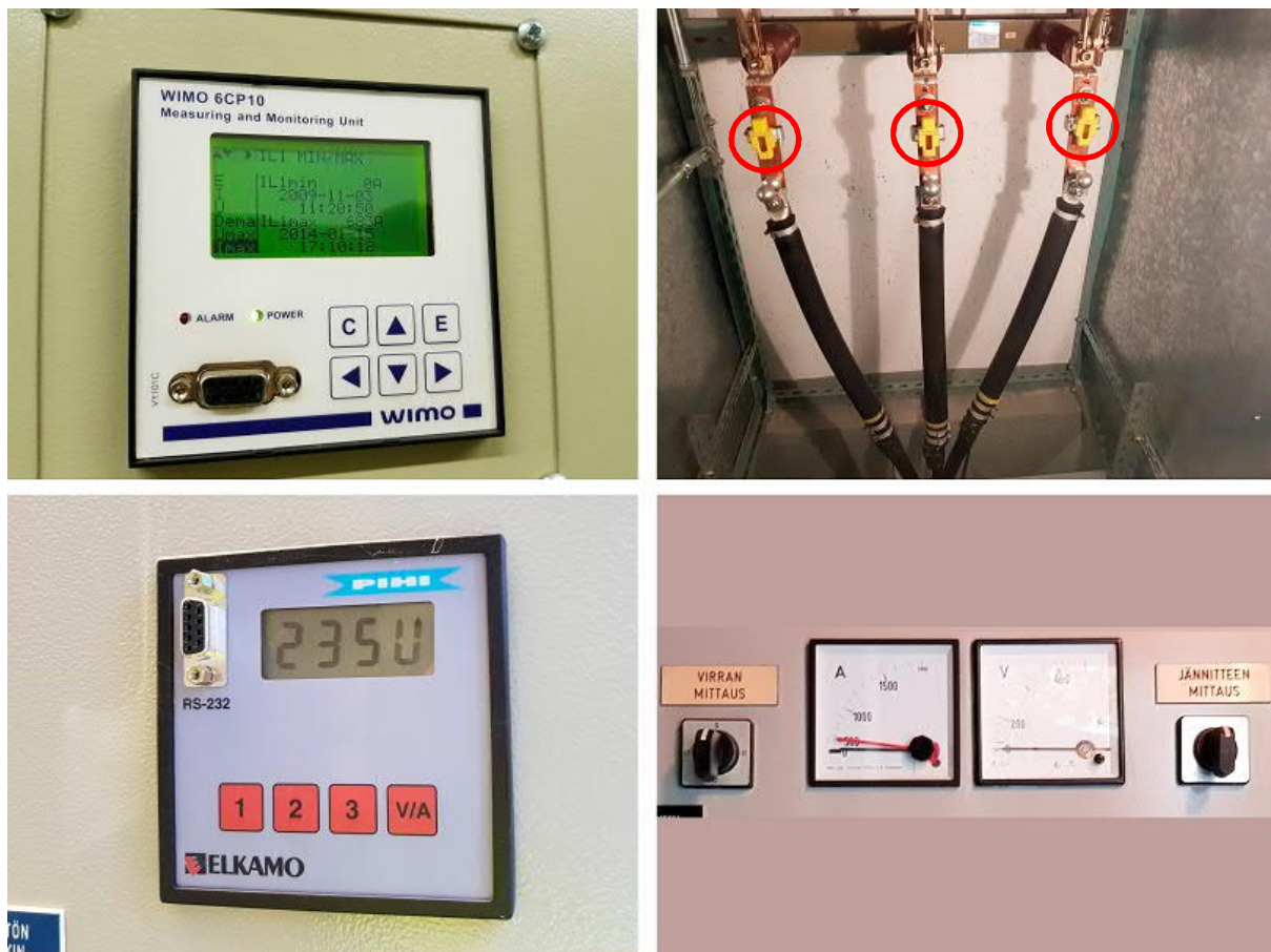
Kuva 32. Esimerkkikuvat WIMO- ja PIHI-mittausyksiköistä (vas.) sekä kaapelipäätteiden vanhoista oikosulkuindikaattoreista ja pienjännitekeskuksen taulumittareista (oik.).
