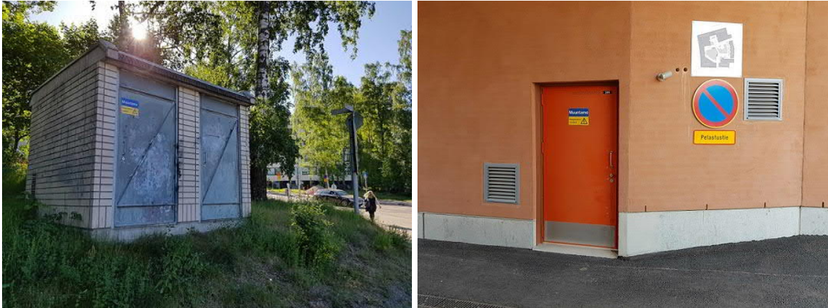
Kuva 19. Esimerkkikuvat erillismuuntamosta (vas.) ja kiinteistömuuntamosta (oik.).
