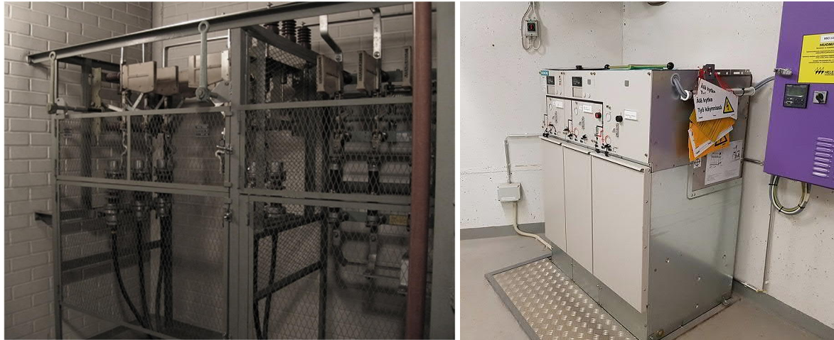
Kuva 21. Esimerkkikuvat avorakenteisesta (vas.) ja koteloidusta (oik.) keskijännitekojeistoista.
