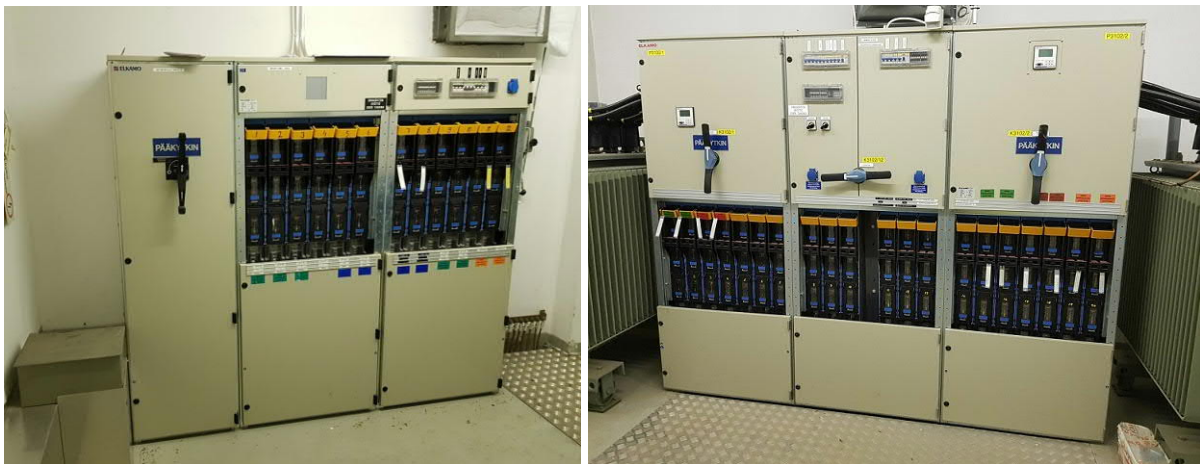
Kuva 28. Esimerkkikuvat muuntamon (vas.) ja kaksoismuuntamon (oik.) pienjännitekeskuksista.
