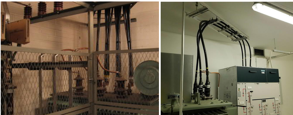
Kuva 25. Esimerkkikuvat kuparijohtimilla (vas.) ja kaapeilla (oik) tehdyistä muuntajaliitännöistä.
