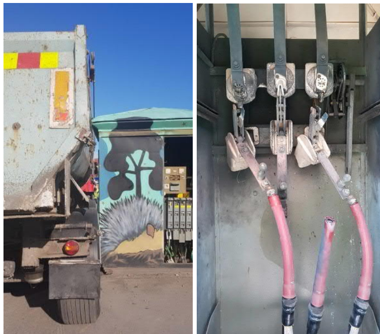
Kuva 22. Avorakenteisen keskijännitekojeiston vikatilanne kesältä 2018.
