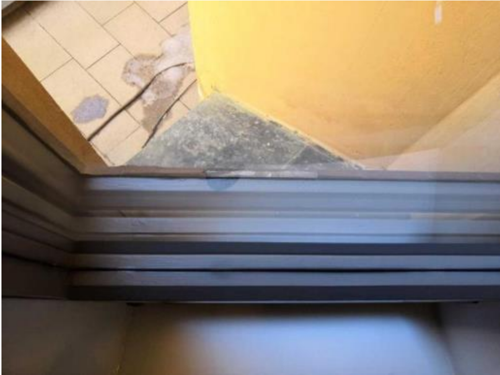
KUVA 6. Ikkunan kittaus ulkopuolella on kärsinyt
