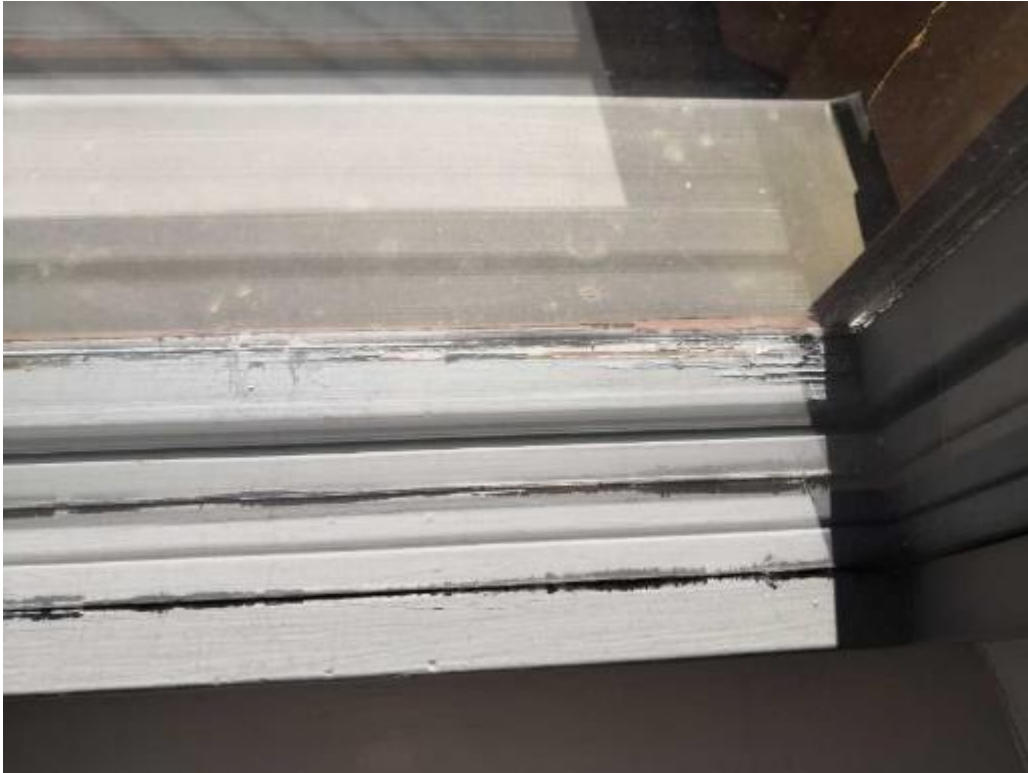
KUVA 5. Ikkunan ulkopuitteen sisäpinnan maali on hilseillyt irti
