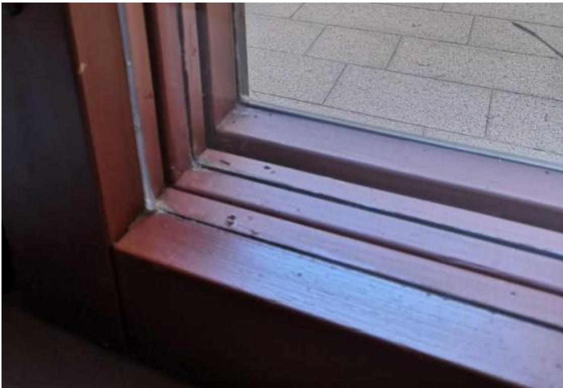
KUVA 2. Ikkunan sisäpuutteen ja lasin välissä on havaittavissa silikonia
