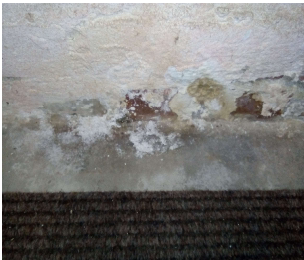
Kuva 12. Kalkkihärmää lattian ja väliseinän liitoksessa.
