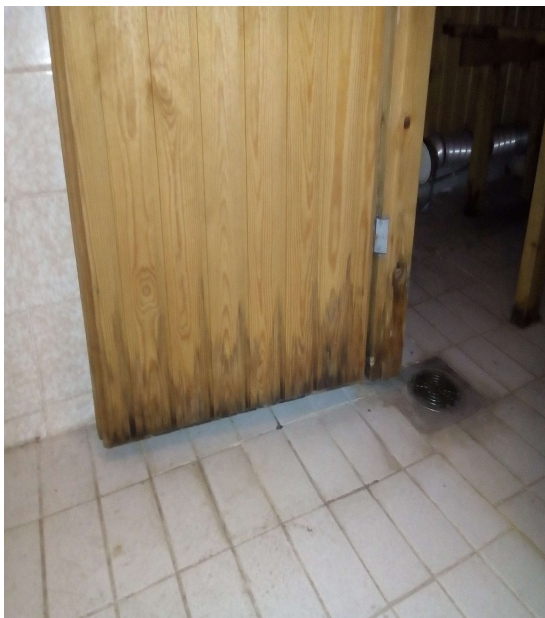
Kuva 10. Saunan ovesa lahoa.
