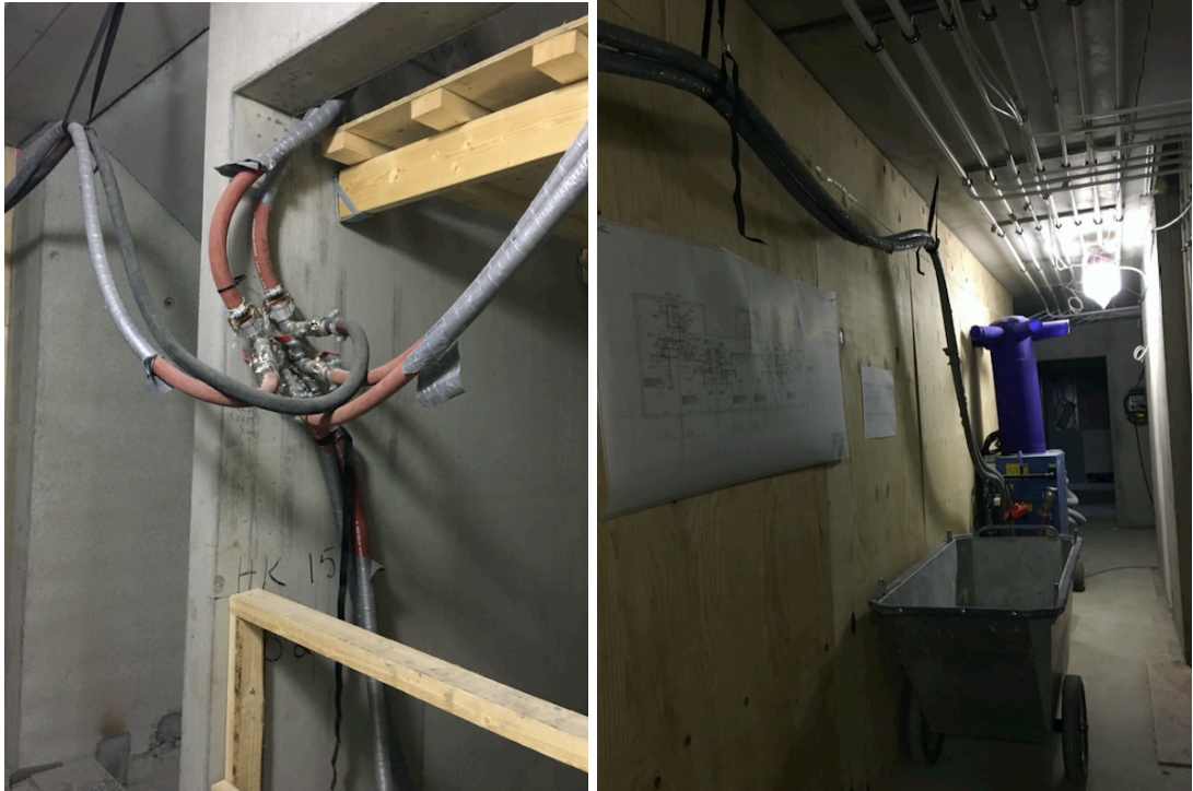
Kuva 65. Vasemmalla kaukolämpöletkujen nousu hissikuilussa. Oikealla kaukolämpöletkut on kuljetettu katon rajassa puhaltimelle. Oma dokumentti.
