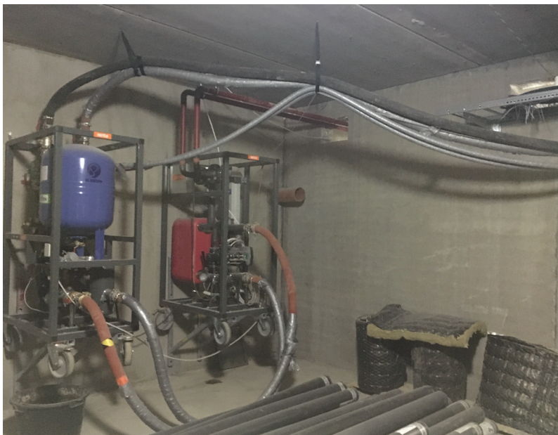
Kuva 64. Tilapäinen kaukolämmönsiirrin sijoitettuna eri tilaan kuin lopullisen kaukolämpöpaketin varsinainen sijoituspaikka tule olemaan. Oma dokumentti.
