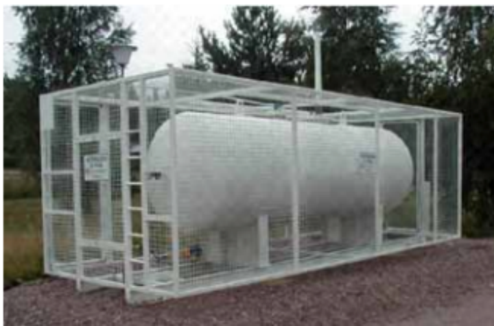
Kuva 44. Tilapäinen nestekaasusäiliö sijoitettuna suojakehikkoon [53].
