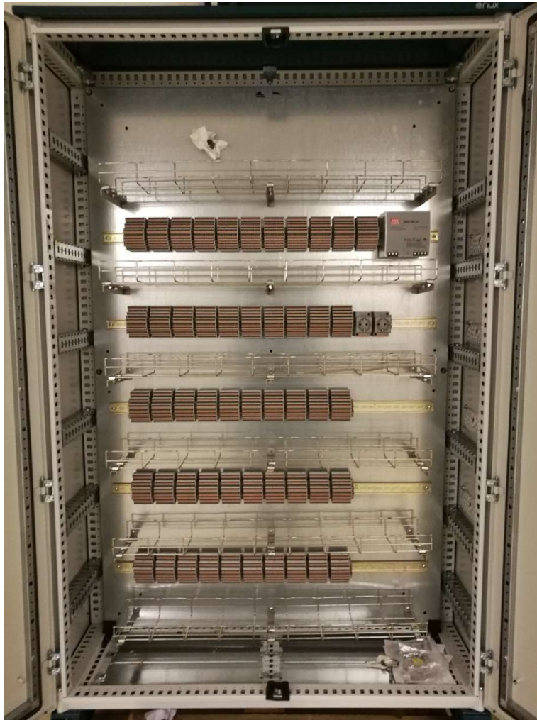
Kuvio 17 Ristikytkentäkaappi kytkentävalmiina.
