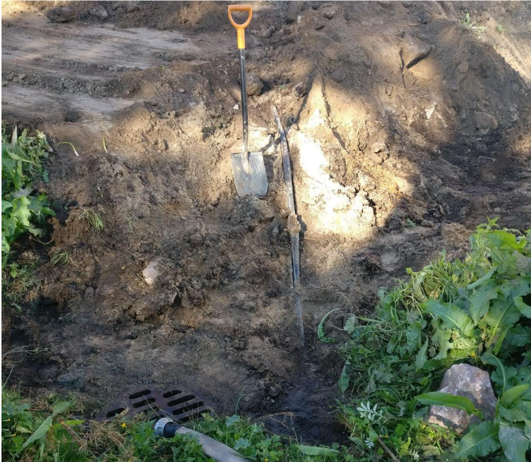
KUVA 11. Sähkön syöttökaapeli taloyhtiön
