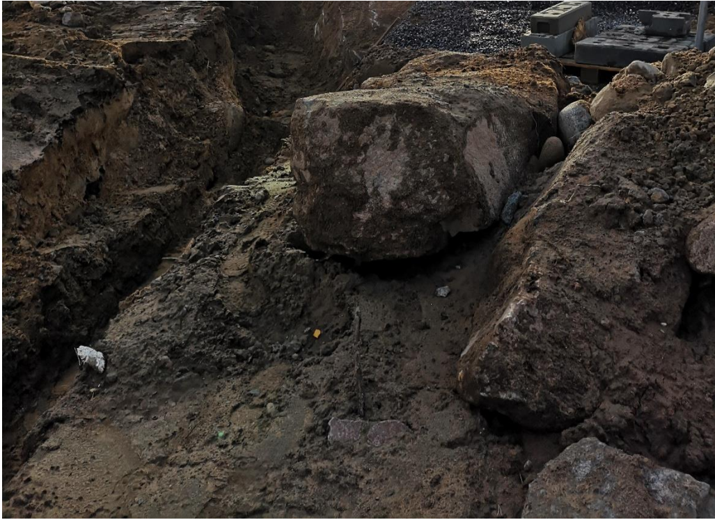
KUVA 12. Sadevesilinjan tiellä oleva iso kivi (1)
