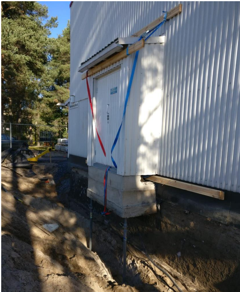
KUVA 10. Sähkökeskuksen tuenta C-talon päädyssä
