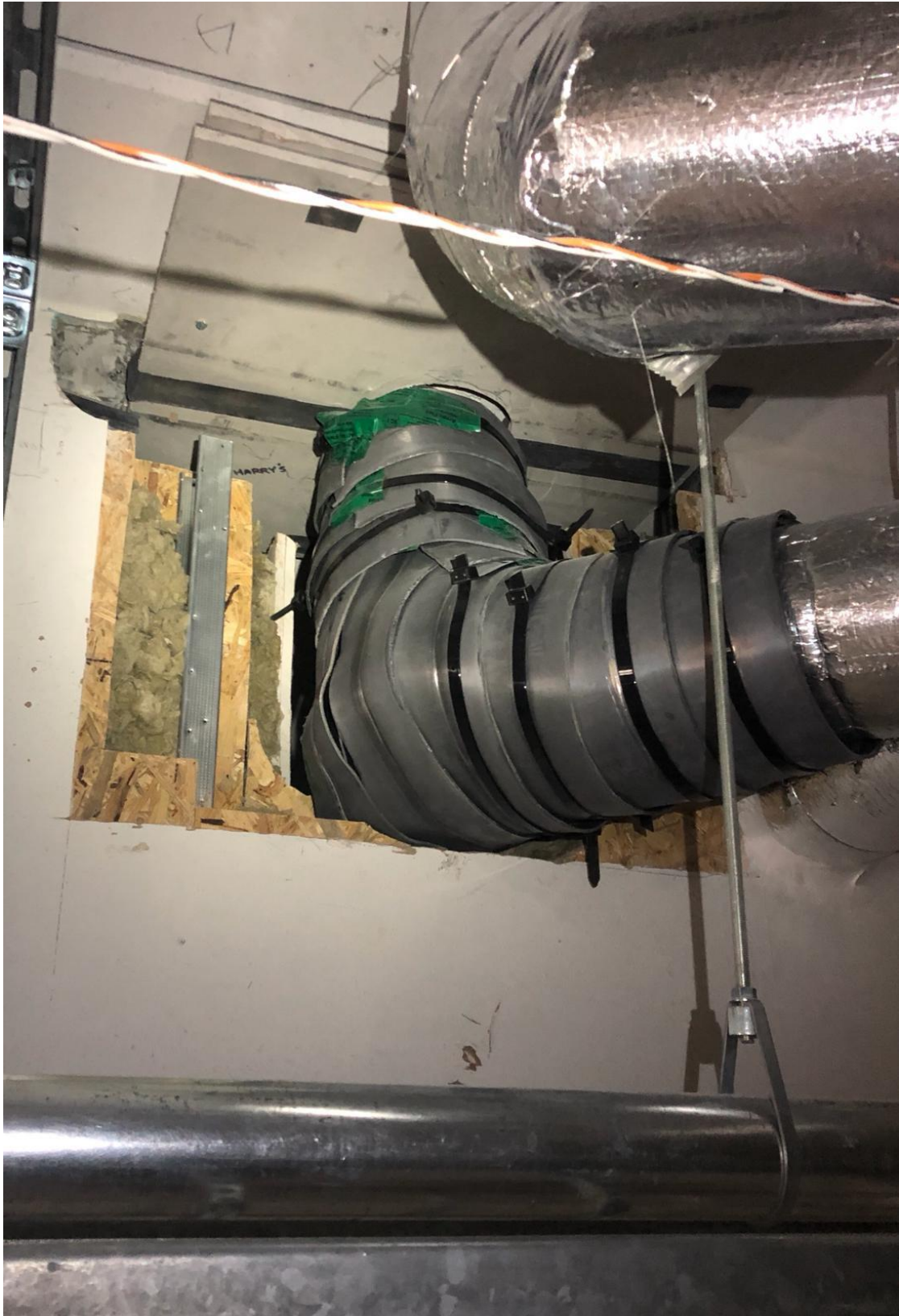
Liite 15. Irtolyijällä vuorattu läpivientiputki.
