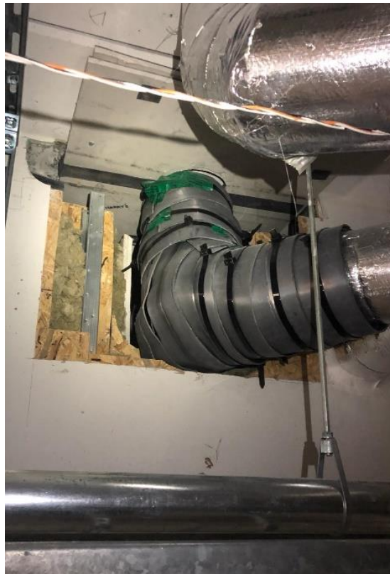
Kuvio 26. Irtolyijyllä vuorattu läpivientiputki.
